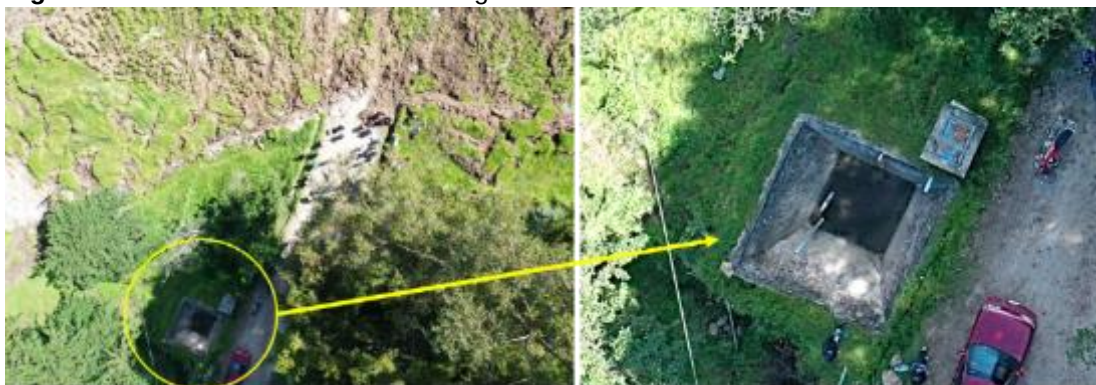
Figura 15. Reservorio expuesto al deslizamiento activo – DA1.
