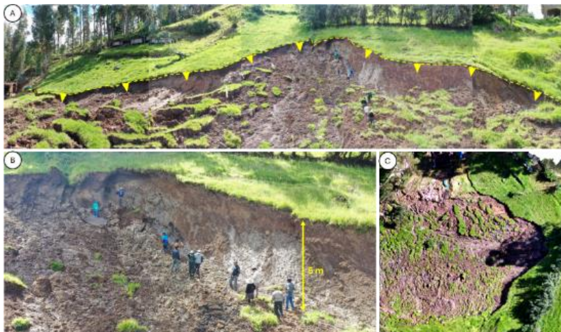
Figura 11. A. Escarpe principal del deslizamiento rotacional activo – DA1, de una longitud de 89 m. B. Salto vertical de la escarpa principal. C. Vista en planta del deslizamiento DA1.
