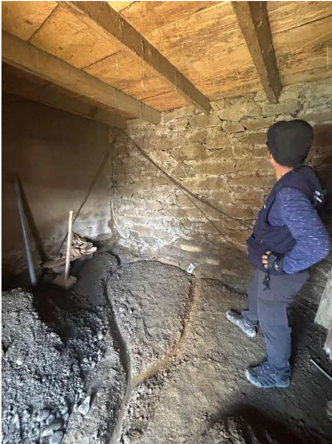
Fotografía 7. Viviendas afectadas por la humedad y filtraciones de agua en las paredes y piso, debido a la saturación del terreno.
