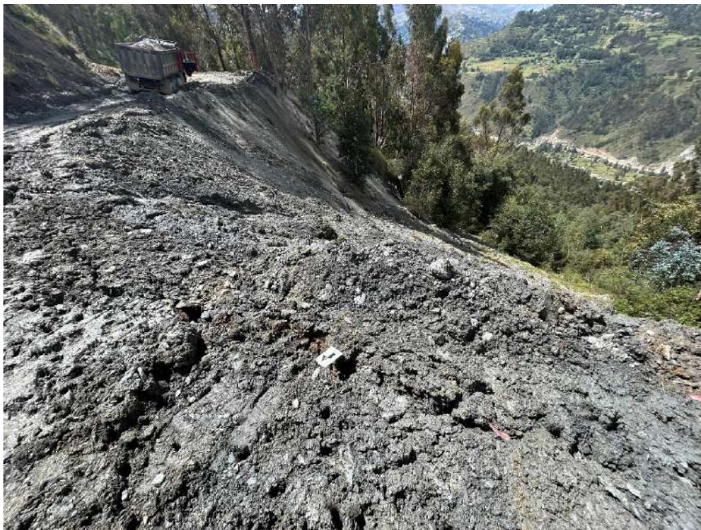
Fotografía 10. Agrietamientos en la vía vecinal no afirmada con longitudes de hasta 2.5 metros, generados por el material inconsolidado y la saturación del mismo, el cual es inestable en temporada de lluvias.
