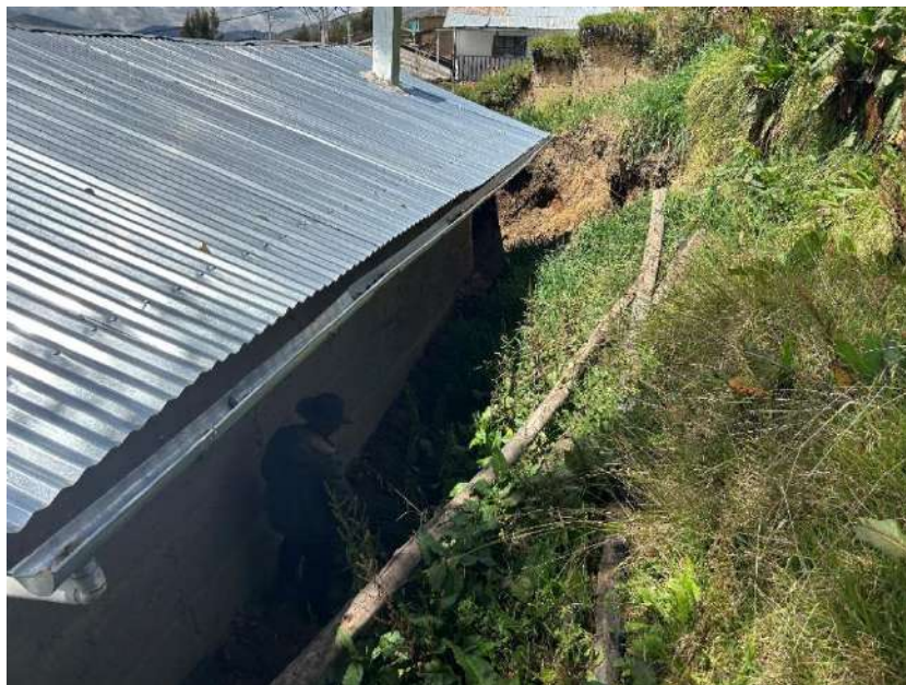
Fotografía 6. Vivienda que podría ser afectada por el terreno inestable del deslizamiento hacia el lado derecho. La vivienda presenta agrietamientos y humedad en las paredes y piso.
