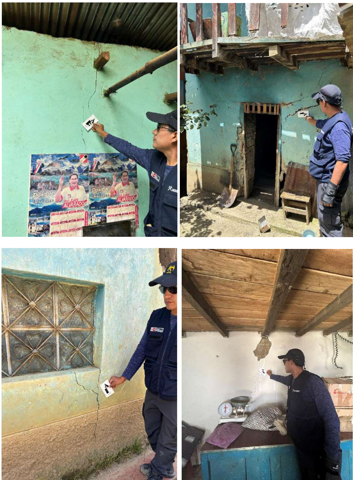
Figura 14. Agrietamientos en las viviendas del Jr. Huánuco del sector Chaupis. Las viviendas presentan grietas en las paredes internas y externas producidas por la inestabilidad del terreno.
