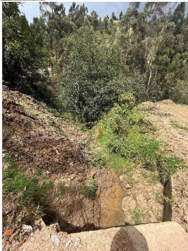
Fotografía 9. Sistema de drenaje sin revestimiento lo que genera infiltración en el terreno y la saturación del mismo. Los depósitos inconsolidados se saturan y debido a las lluvias intensas se generan movimientos en masa como deslizamientos y derrumbes.
