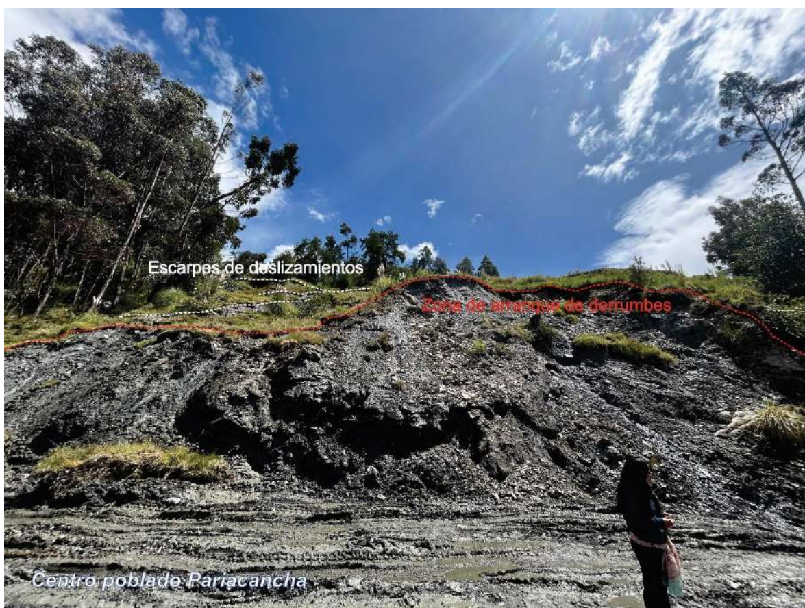
Figura 16. Escarpes de deslizamientos en el centro poblado Pariacancha, así como derrumbes que afectan la vía vecinal no afirmada de acceso al sector de Chaupis. Se evidencia el terreno saturado debido a la inadecuada canalización del drenaje en la zona.
