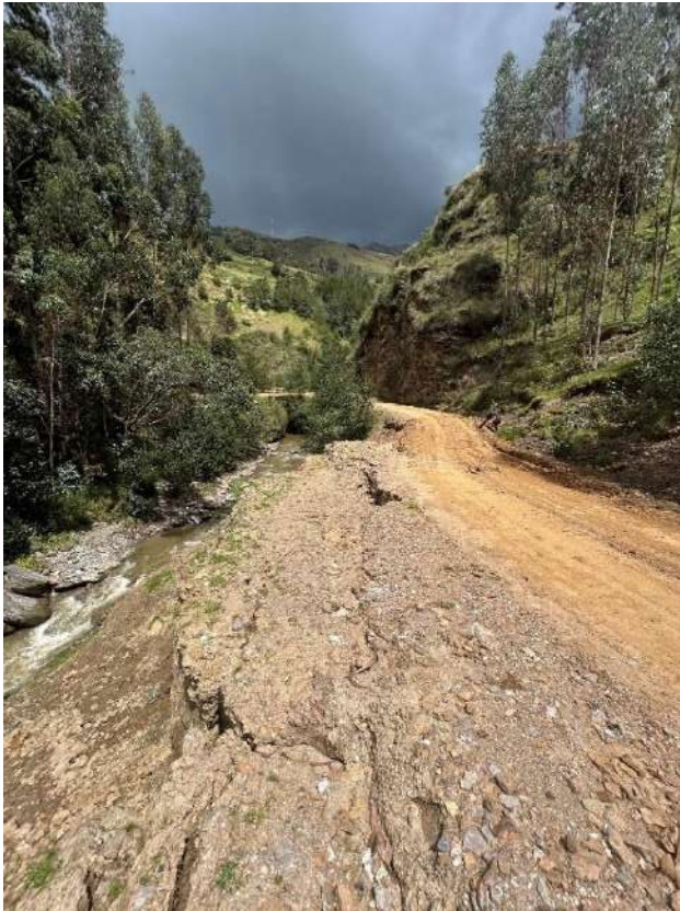
Fotografía 8. Agrietamientos en la vía de acceso al sector Chaupis, generados debido al material inconsolidado y saturado, el cual podría colapsar en temporada de lluvias, hacia la quebrada Pomavado.
