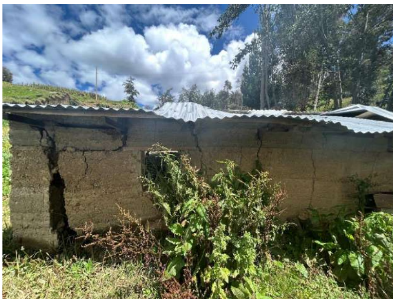
Fotografía 5. Vivienda inhabitable ubicada en el cuerpo del deslizamiento en el sector Chaupis.
