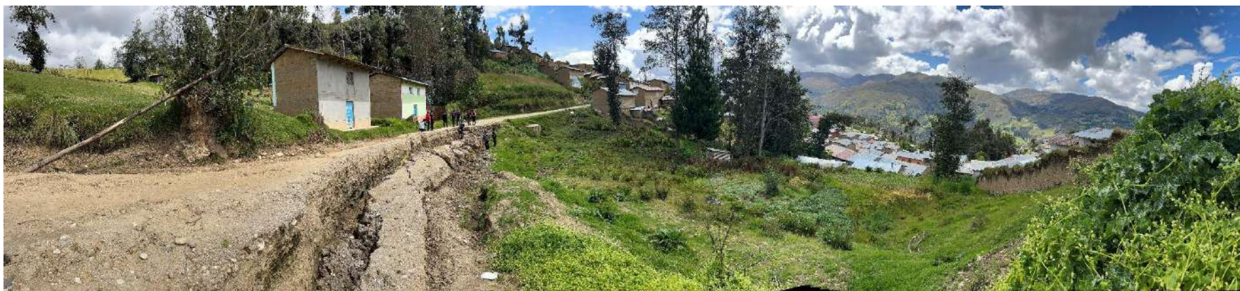
Fotografía 2. Vista hacia el noroeste del deslizamiento en el sector Chaupis, el cual afecta la vía vecinal de acceso al sector en mención.
