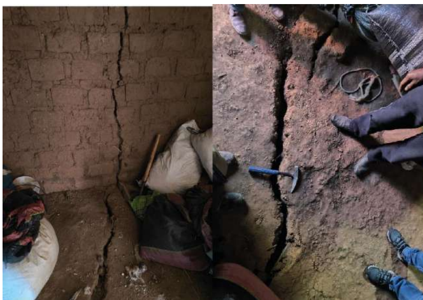
Figura 11. Grietas que atraviesan viviendas y generan agrietamientos significativos en los muros de viviendas, evidenciando la afectación directa de la estructura.
