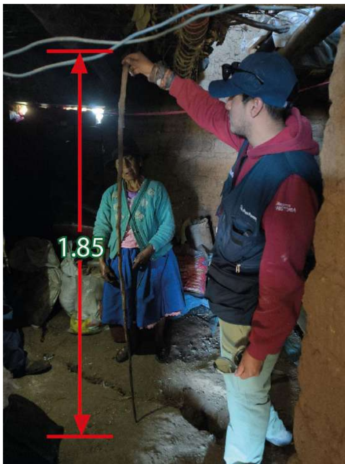
Figura 10. Grietas con profundidad estimada de hasta 1,85 m, cuya base no fue alcanzada durante la inspección, atravesando de forma longitudinal una vivienda construida sobre la zona afectada.
