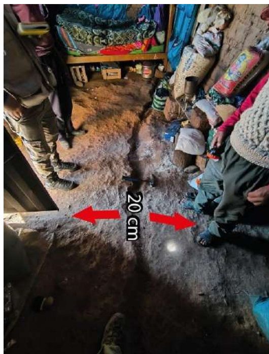
Figura 9. Agrietamientos de apertura aproximada de 20 cm, dispuestos de forma subparalela al eje principal del movimiento. Estas grietas corresponden a fisuras de tensión generadas por deformación
