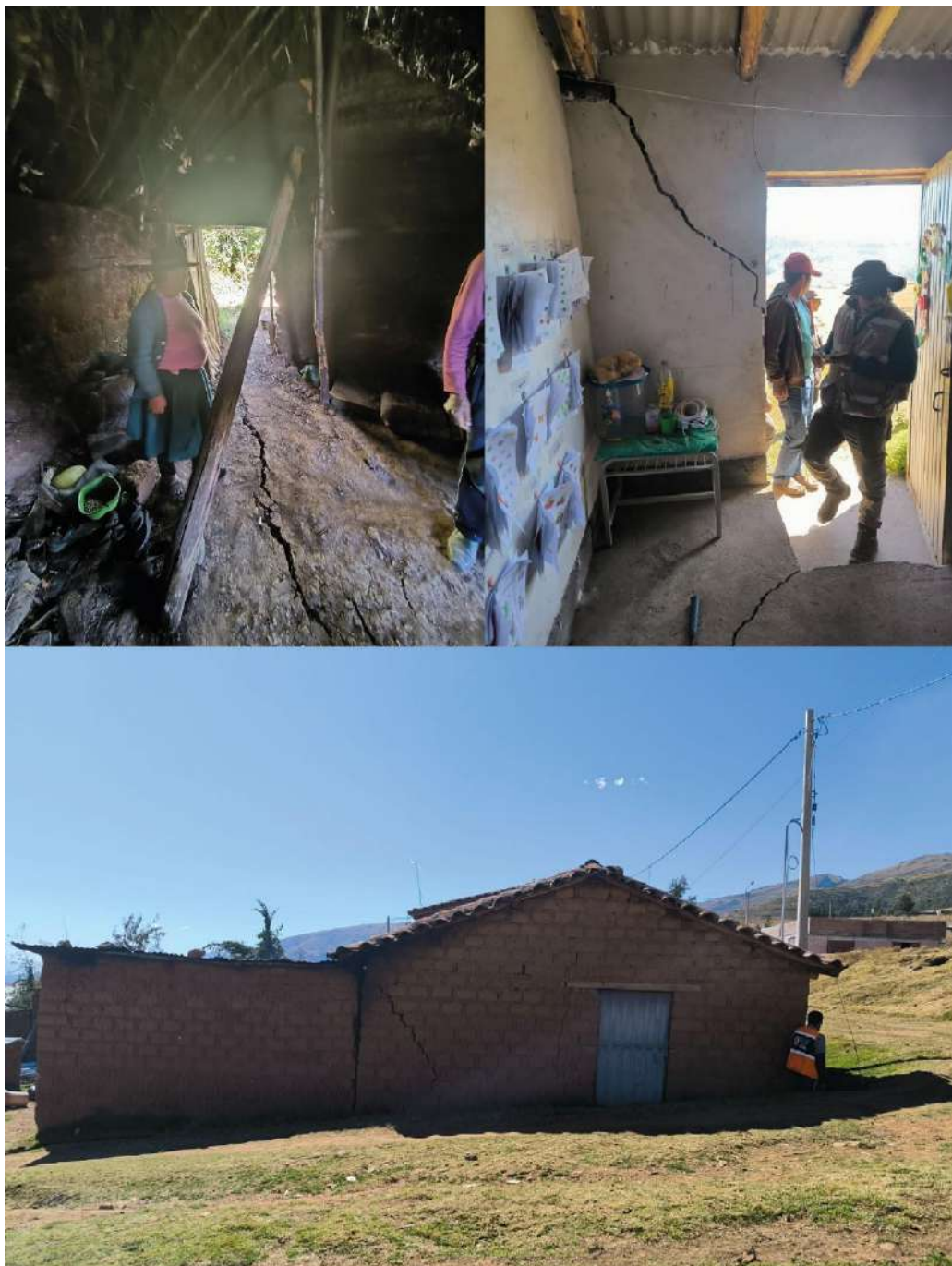
Figura 12. Registro de agrietamientos en el centro poblado de San Francisco de Cuchicancha, asociados a deformaciones diferenciales del terreno y pérdida de capacidad portante en el subsuelo, lo que evidencia un proceso activo de inestabilidad que afecta edificaciones y superficies pavimentadas.
