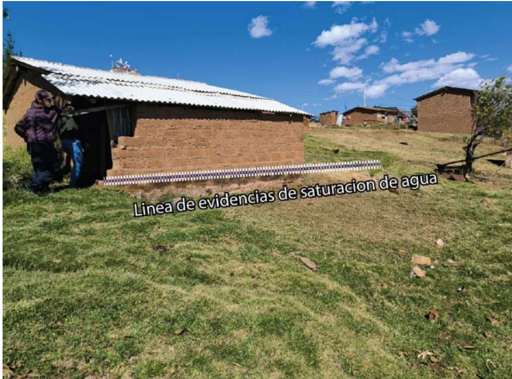
Figura 6. Evidencias de saturación del terreno, manifestadas en abombamientos y ondulaciones en la superficie del suelo. Se observa que las viviendas se encuentran a escasos 30 cm entre sí, lo que limita el drenaje superficial, favoreciendo la acumulación de humedad. Esta proximidad, sumada a la naturaleza de los depósitos coluvio-aluviales y la ausencia de sistemas de evacuación de aguas pluviales, ha incrementado la infiltración de agua en las cimentaciones y muros de las viviendas, propiciando procesos de reptación y deformación diferencial en el terreno.
