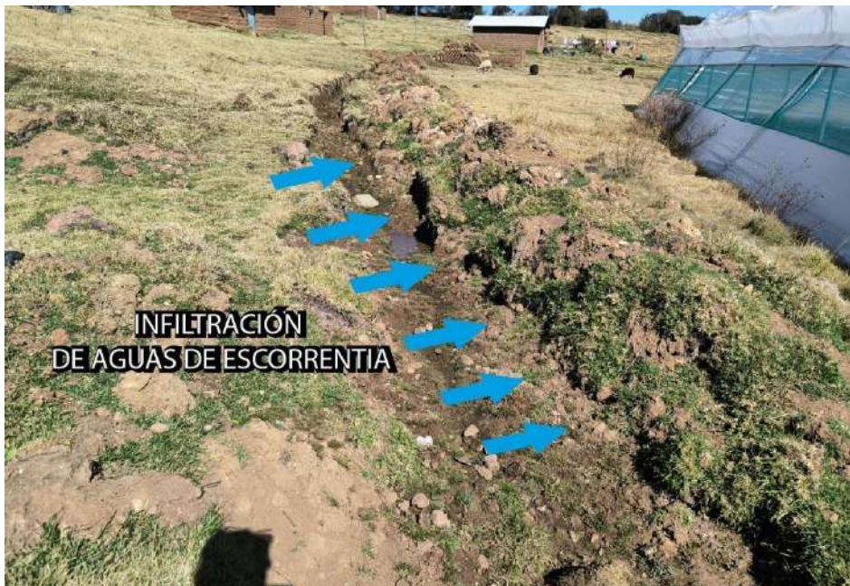
Figura 7. Zanjas de drenaje sin revestimiento, las cuales permiten la infiltración directa de las aguas pluviales y de escorrentía hacia el subsuelo, incrementando la saturación del terreno. Esta condición favorece la pérdida de capacidad portante del suelo y aumenta la susceptibilidad a procesos de inestabilidad superficial y subsuperficial.
