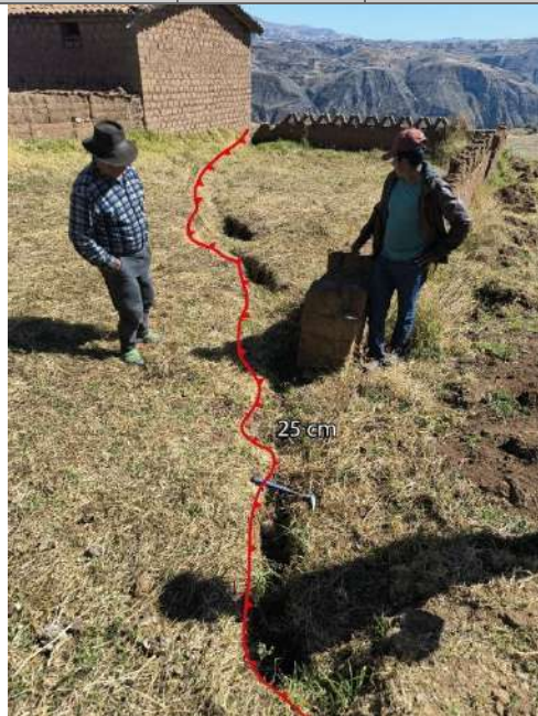
Figura 8. Salto de escarpe de aproximadamente 25 cm, correspondiente al deslizamiento de tipo rotacional previamente descrito. Este escarpe representa el límite superior de la superficie de ruptura y evidencia un movimiento diferencial del terreno.
