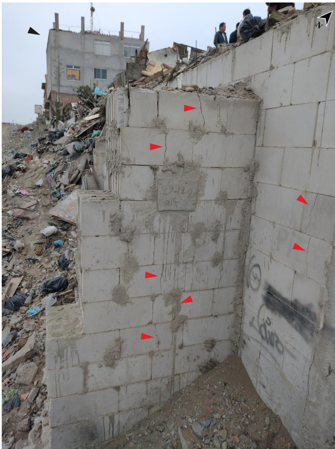
Figura 15. Muro de contención ubicado en la cresta del Lomo de Corvina, en la parte sur del sector evaluado. Este muro presenta rajaduras en la parte inferior y superior, esto pone en evidencia la presión que ejerce el material de relleno y las viviendas sobre el muro y la inestabilidad del substrato arenoso.
