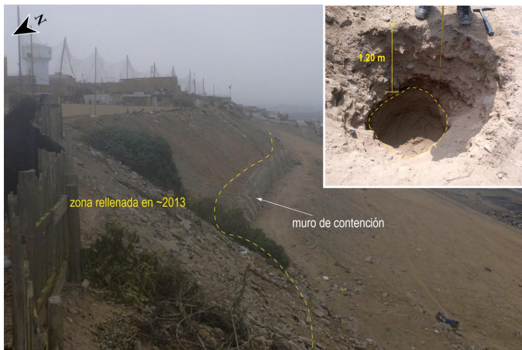
Figura 18. Zona rellenada en el año ~2013 con material de gravas y limoarcillas en la parte superior llega a tener 1.20 m de espesor. Este relleno, se realizó sobre el muro de contención que actualmente presenta rajaduras, ubicado en la cresta del Lomo de Corvina.
