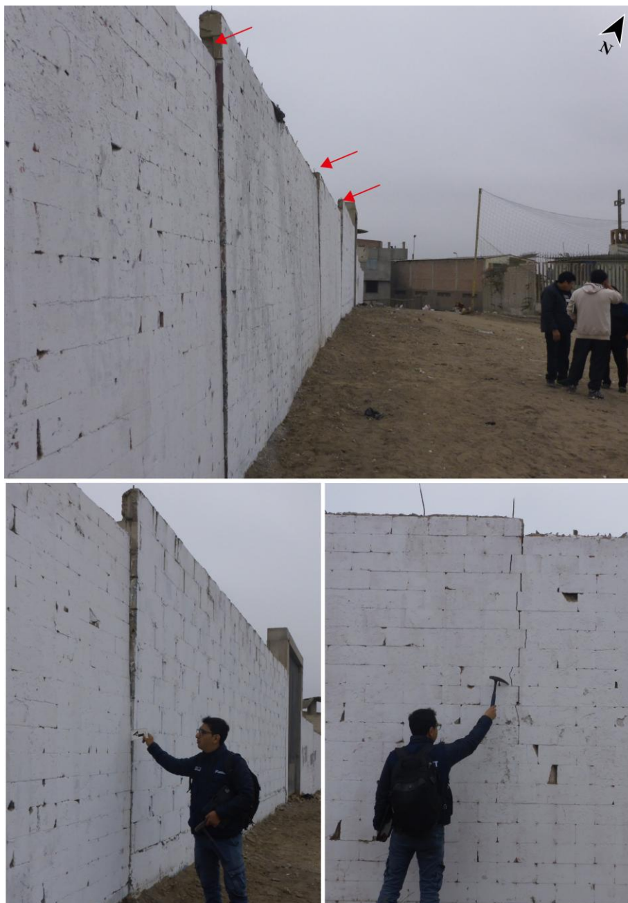
Figura 21. Muro con desplazamiento horizontal en las paredes, que van de 4 a 8 cm de separación, asimismo, se observa rajaduras en la pared. Ubicado en la zona norte del sector evaluado.
