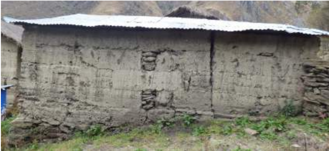
Fotografía 3: Vivienda afectada debido a la reactivación del deslizamiento D3. Coordenadas referenciales UTM WGS-84, 18S E:319754, N:8945202.
