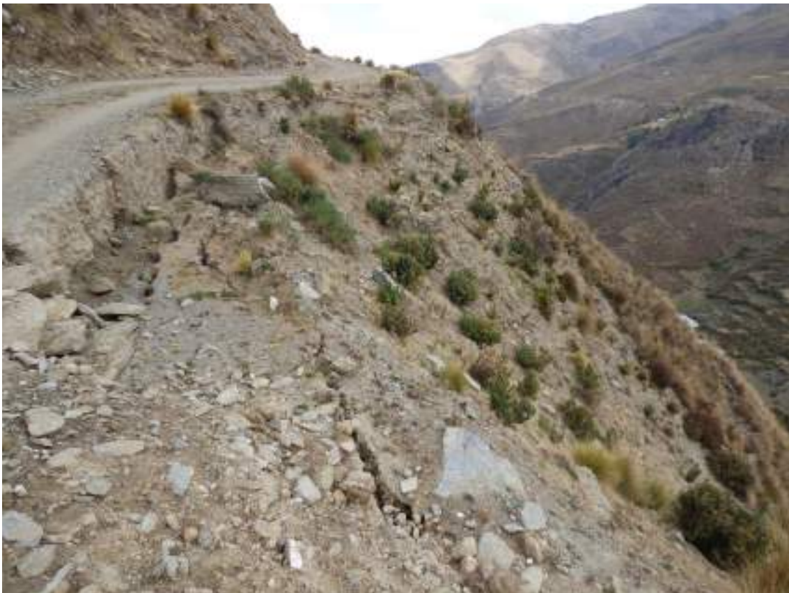
Fotografía 4: Grietas tensionales ubicadas en el talud inferior de la carretera, las cuales podrían comprometer la seguridad física de la vía. Ubicación referencial progresiva 6+700.
