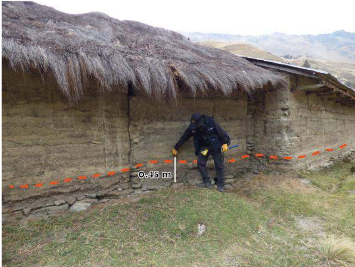
Figura 31: Huellas o marcas de flujo reciente en pared de vivienda que muestra una altura de 0.45 m. Coordenadas referenciales UTM WGS-84, 18S E: 319177, N: 8947260.
