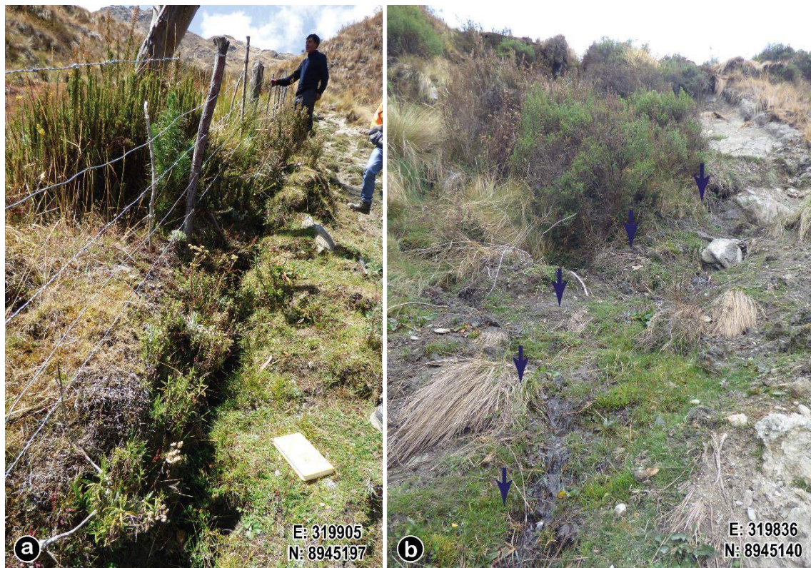
Figura 17: Canales de riego sin impermeabilizar, que saturan constantemente el terreno e incrementan su caudal en temporada de avenida. Coordenadas referenciales UTM WGS-84, 18S, señaladas en cada fotografía.
