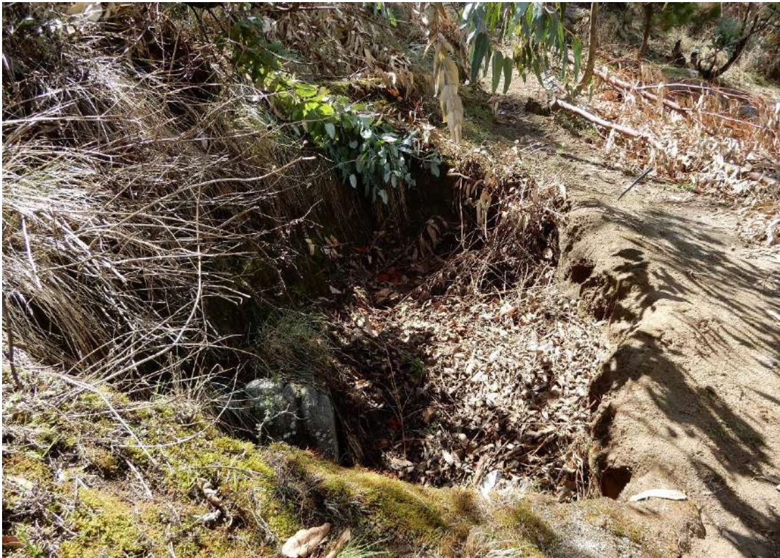
Fotografía 11. Vista de depresiones en la ladera oeste, por donde puede llegar a infiltrar mayor cantidad de agua.
