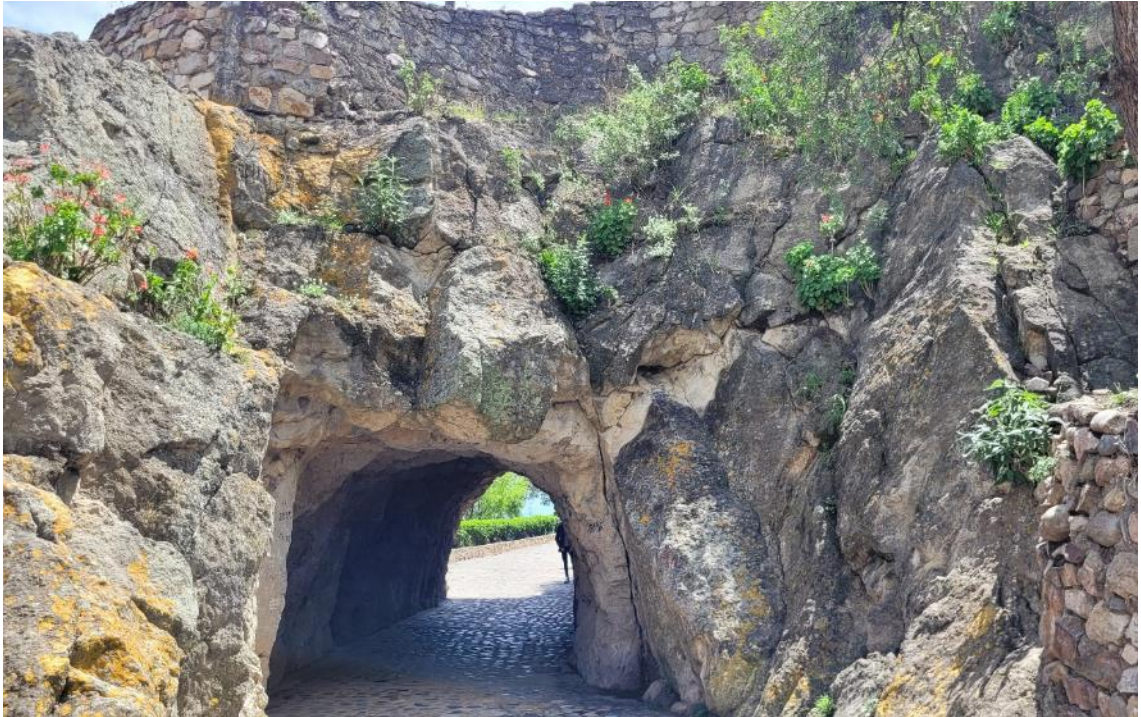
Figura 10. Lado oeste del túnel, moderadamente meteorizado y medianamente a muy fracturado.
