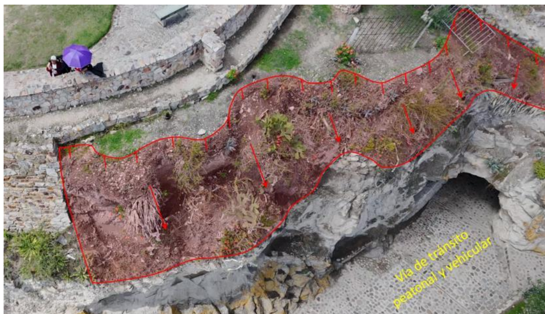
Figura 6. Vista aérea de la zona de arranque del derrumbe (relleno antrópico), se observa la dirección del material en dirección a la vía de tránsito de vehículos y personas en la parte baja.
