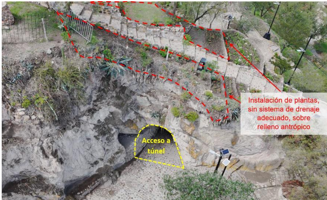
Figura 8. Vista aérea de la zona de arranque del derrumbe (relleno antrópico), se observa la dirección del material en dirección a la vía de tránsito de vehículos y personas en la parte baja.
