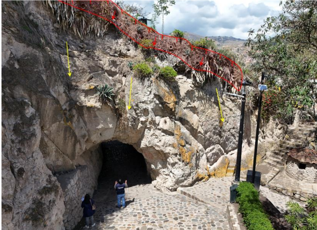
Figura 7. Se observa la zona de arranque del derrumbe (relleno antrópico), en dirección a la vía de tránsito de vehículos, personas y en la entrada del túnel.
