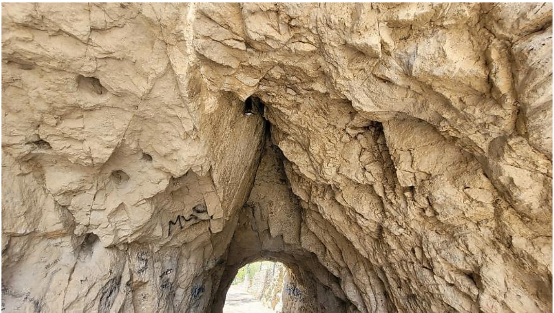
Figura 11. Bóveda (techo del túnel), se observa la roca muy fracturada.
