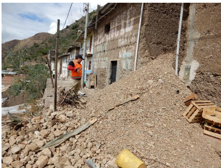
Fotografía 2: Se aprecia el material que ha desplazado por un callejón y formó un cono de detritos.
