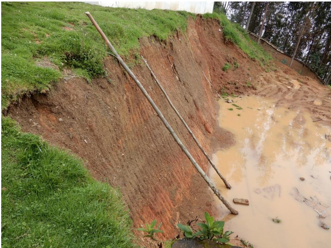
Fotografía 8. Detalle de la Unidad de vertiente Coluvio-deluvial conformado por material incompetente e inconsolidado dispuesta sobre ladera con pendiente muy pronunciada que va de 25° a 45°. Vista mirando al norte.
