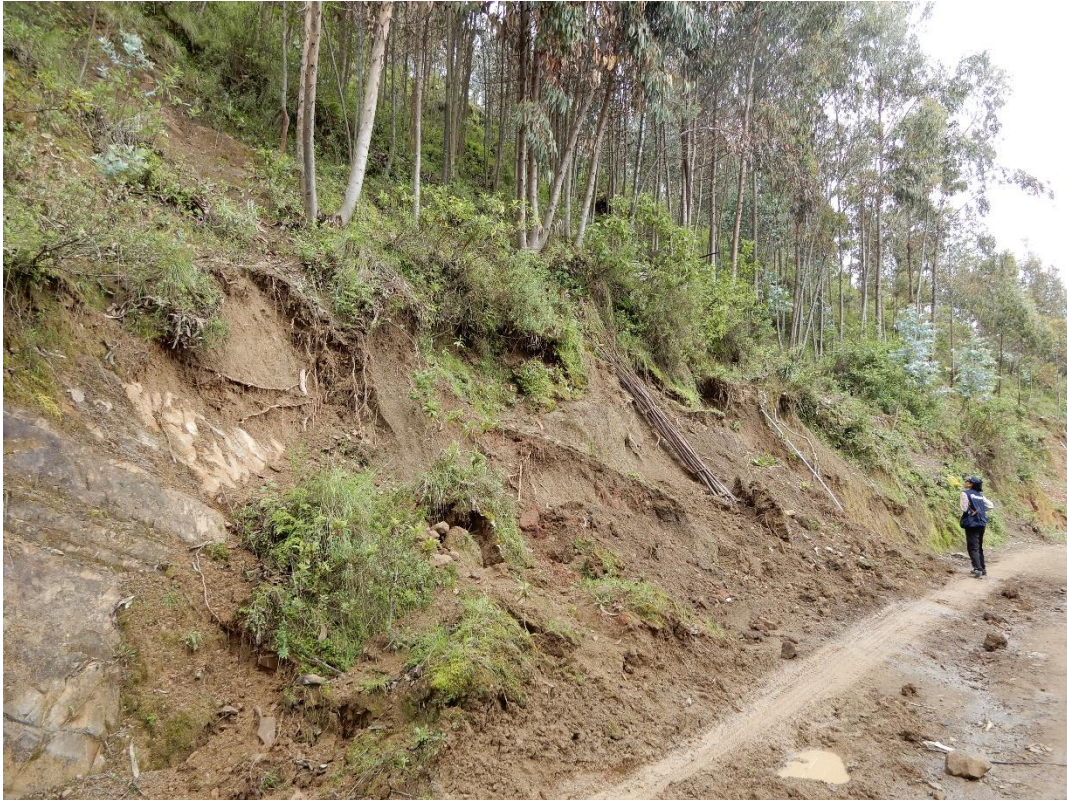
Fotografía 11. Derrumbes en el tramo de la carretera llegando a la I.E N°82005.
