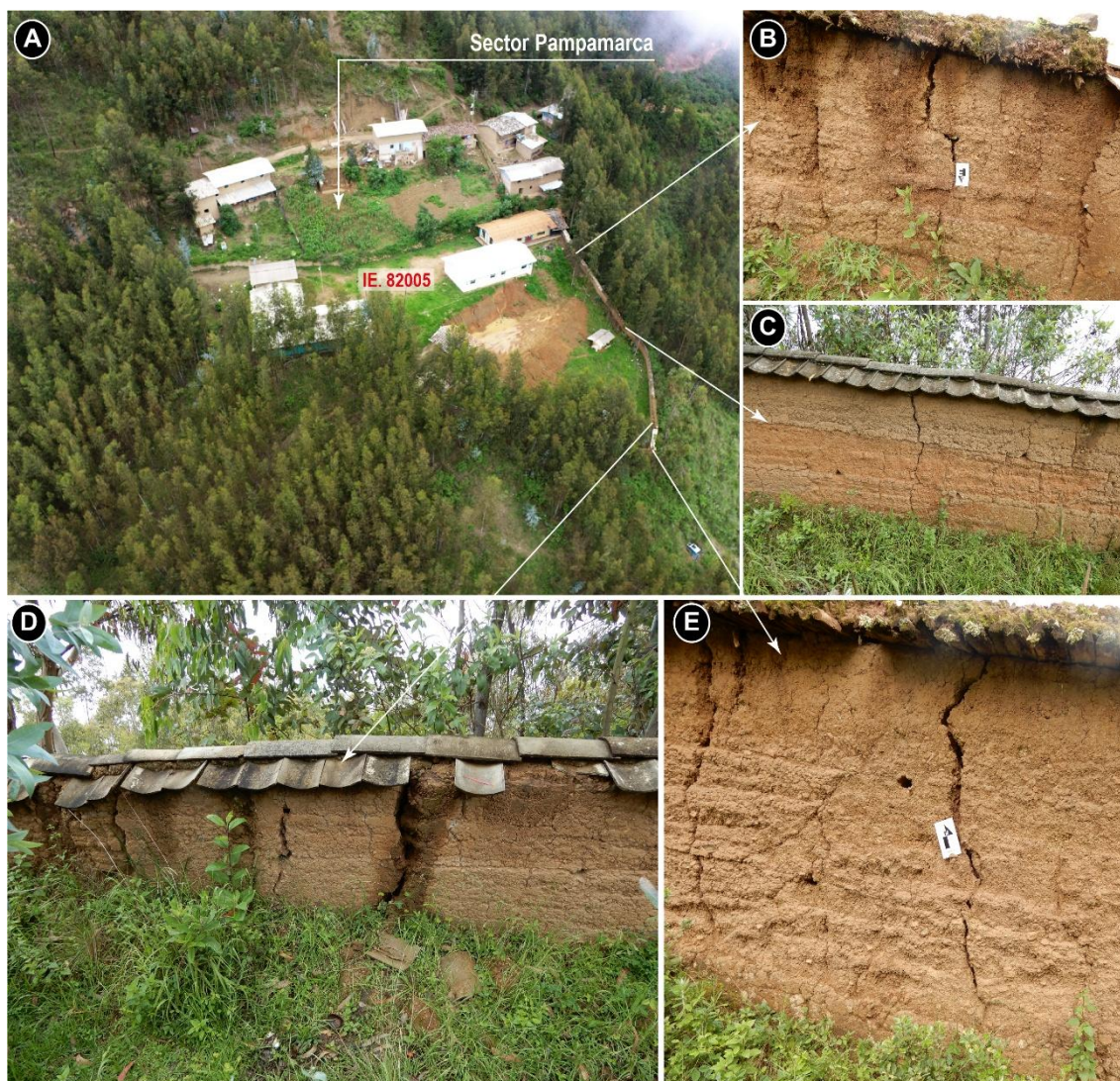
Figura 11. Grietas y fisuras que atraviesan el cerco perimétrico de la I.E 82005 que ponen en evidencia de deformaciones diferenciales del terreno dentro del cuerpo del deslizamiento activo.
