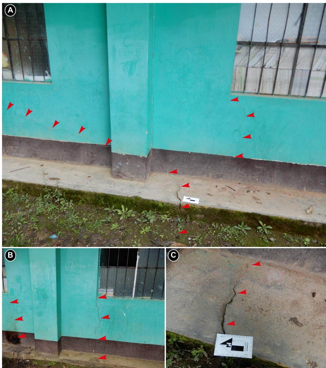
Figura 10. Grietas que atraviesan transversalmente la parte lateral de la I.E 82005 de Pampamarca.
