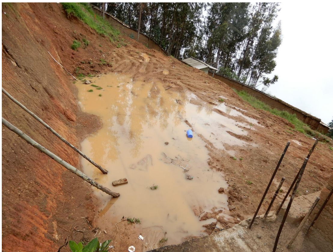
Fotografía 10. Excavación y cortes de talud ocasiona acumulación de agua que sobresatura los depósitos inconsolidados en el cuerpo principal del deslizamiento.
