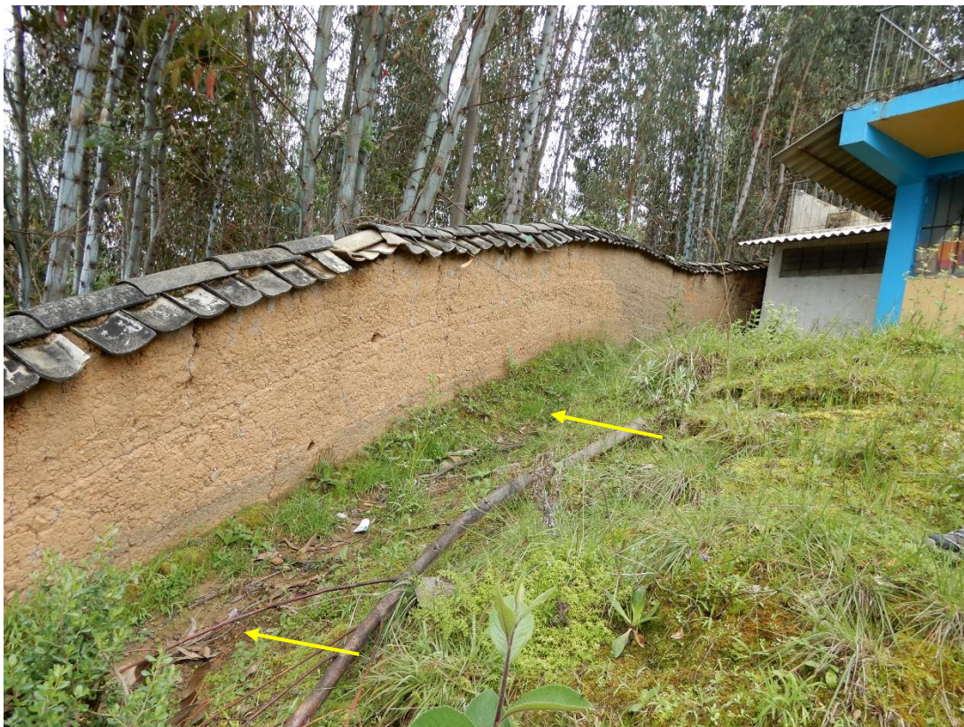
Fotografía 9. Canales (indican flechas amarillas) sin revestir que discurren hacia el cuerpo principal del deslizamiento.
