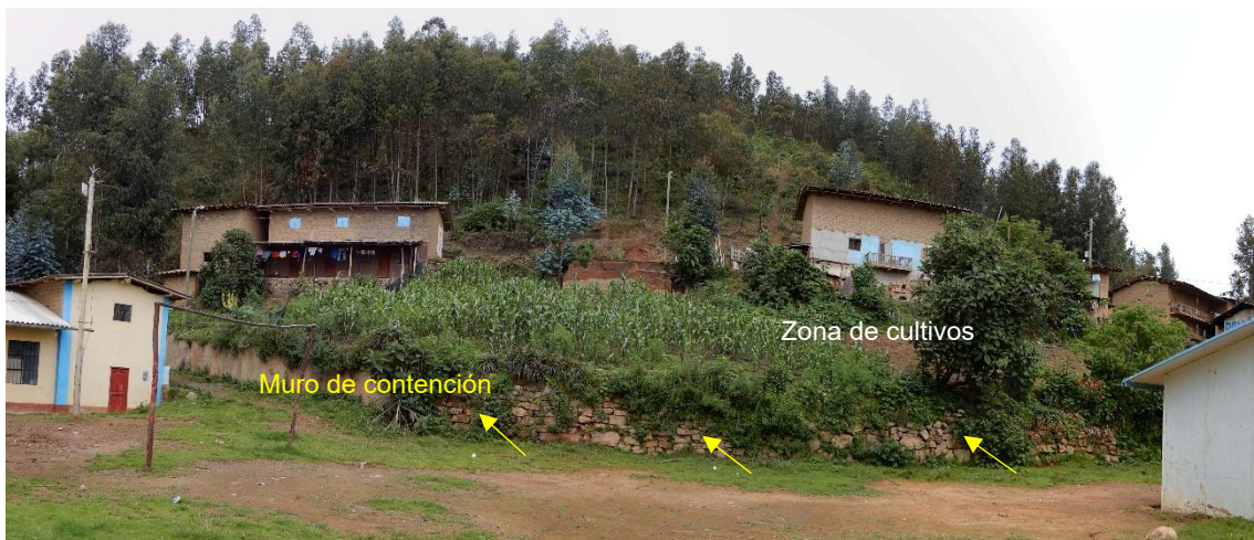
Fotografía 12. Zonas de cultivo y muro de contención (flechas amarillas) sobre el deslizamiento activo en el sector Pampamarca. Nótese, las viviendas ubicadas sobre estos terrenos inestables.
