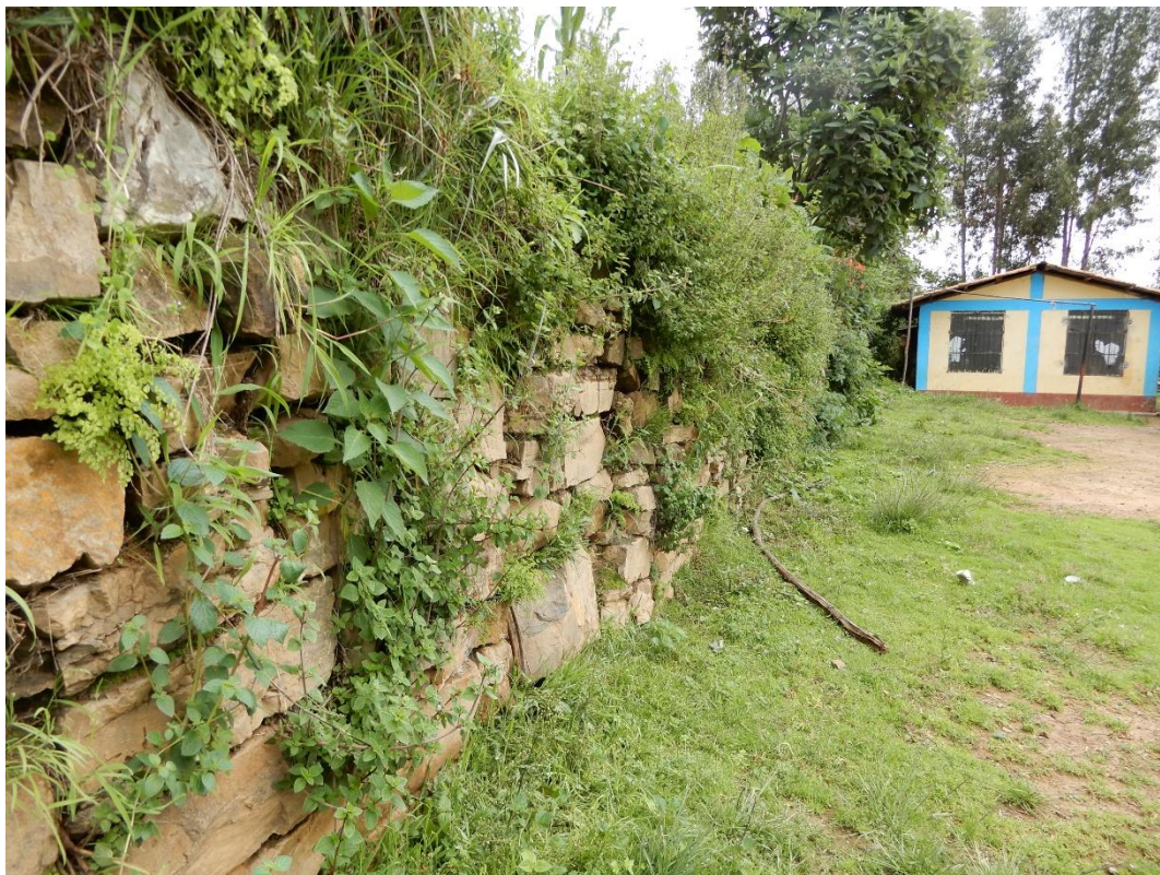
Fotografía 13. Muro de contención de piedras con claras evidencias de deformaciones diferenciales del terreno que ponen en evidencia el movimiento progresivo y activo del deslizamiento.
