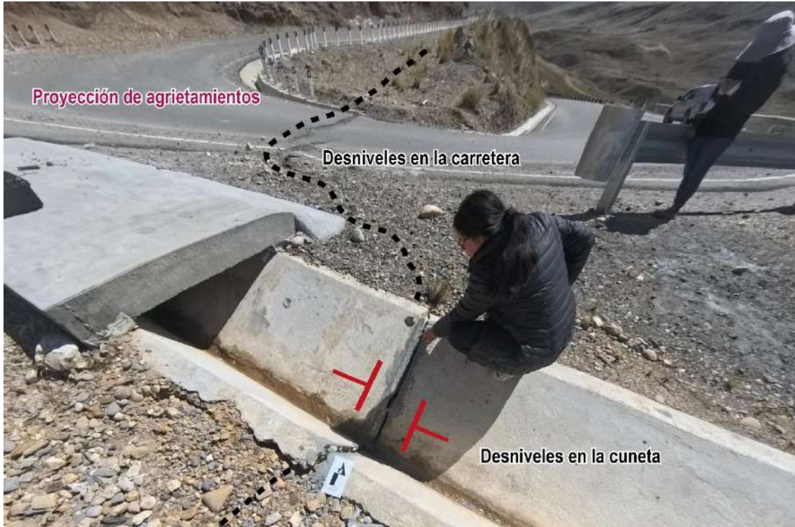
Figura 8: Agrietamientos en la carretera y cuneta, con desniveles observados de 0.06 m y 0.09 m respectivamente. La proyección del agrietamiento presenta una longitud de aproximadamente 40 m. Coordenadas referenciales UTM WGS-84, 18S E:466028, N:8641759.
