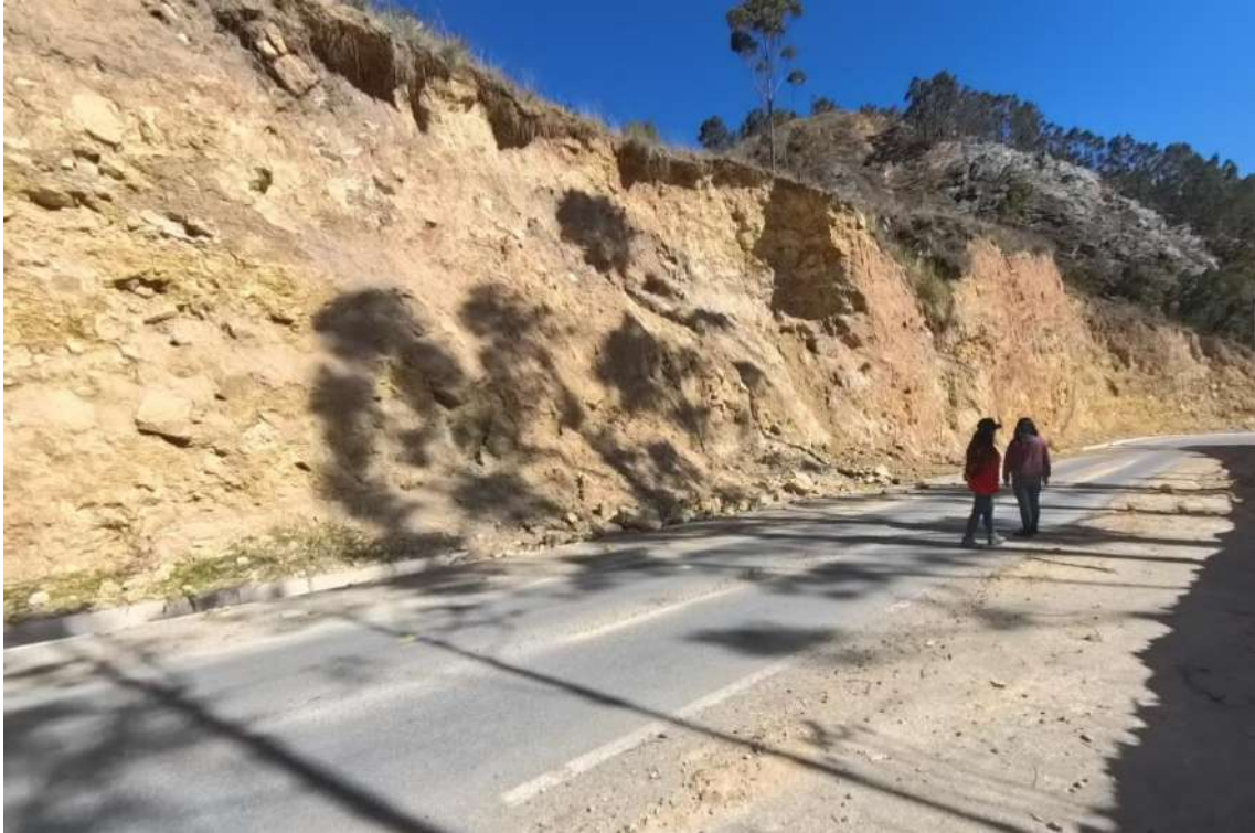
Fotografía 11. Derrumbes superficiales, condicionado por depósitos coluvio-deluviales sueltos y poco consolidados, originado a partir de movimientos en masa antiguos, que afectan la vía entre las progresivas 48+700 y 48+800.
