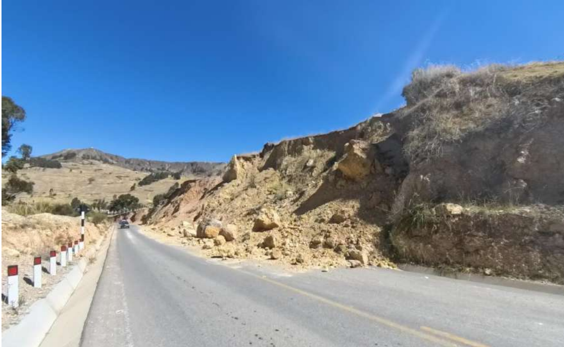
Fotografía 12: Afectaciones en la vía Chicche – Chongos Alto, entre las progresivas 41+400 y 41+600, producto de la reactivación al pie de un deslizamiento antiguo, obstruyendo la carretera en un tramo de 100 m de longitud y 5 m de ancho.
