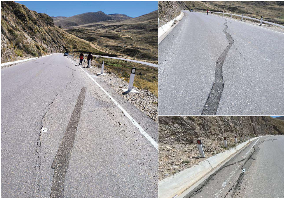
Figura 9: Agrietamientos longitudinales en distintos tramos de la carretera, específicamente entre las progresivas 36+600 y 36+800 (sector Vista Alegre) los cuales presentan aberturas progresivas desde su aparición en junio de 2024. La evolución temporal de estas grietas evidencia un proceso activo de deformación diferencial del terreno, lo que compromete la estabilidad estructural de la vía.
