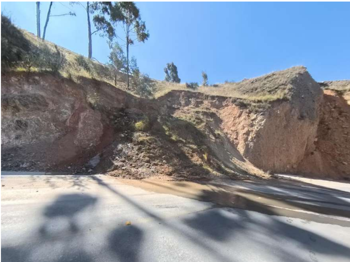
Fotografía 13: Reactivaciones superficiales en el cuerpo de un deslizamiento antiguo, que afecta la vía entre las progresivas 46+500 y 46+600. Obsérvese la saturación de los materiales coluvio-deluviales que favorece la inestabilidad del talud.
