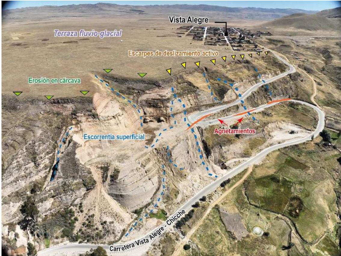
Figura 7. Vista panorámica del Sector A , trazo de la Carreta Vista Alegre – Chicche (Prog. 36+200 hasta la Prog. 37+500), afectado por deslizamientos activos (triángulos de color amarillo) influenciado por la escorrentía superficial (líneas entre cortadas azules).
