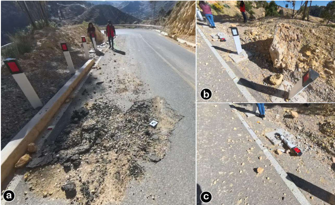
Figura 13: Afectaciones en la vía Chongos Alto – Huasicancha, entre las progresivas 51+600 y 51+800. a. Marcas de impacto en la vía, debido a la caída de rocas, desprendidos desde las zonas altas de las laderas. b. Bloques de roca de hasta 1.3 m de diámetro. c. Daños en postes delineadores.
