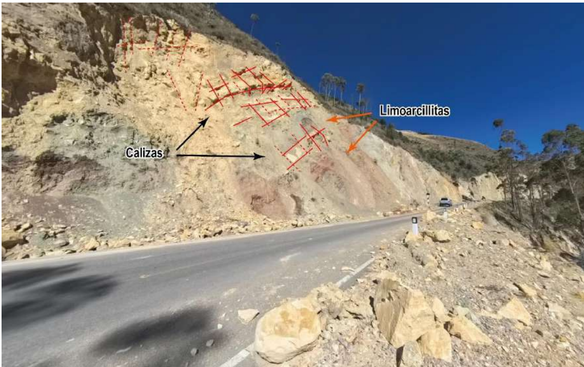
Figura 12. Macizo rocoso formado por una intercalación de calizas y limoarcillitas de tonalidades pardas, grisáceas y blanquecinas. Las calizas presentan un alto grado de fracturación, lo que favorece la formación de bloques inestables. Por su parte, las limoarcillitas corresponden a estratos de baja competencia, fácilmente meteorizables y con pérdida de resistencia al saturarse, lo que favorecen lo derrumbes.
