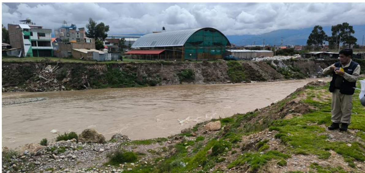
Fotografía 9. Vista de la margen izquierda del río Cunas con procesos de socavamiento lateral.
