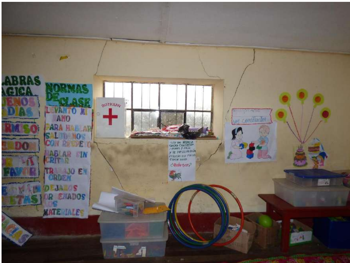
Fotografía 7: Grietas de 2.0 cm de abertura en pared de aula, condicionado por la sobresaturación del terreno sobre la cual se asienta la Institución Educativa N° 32742.
