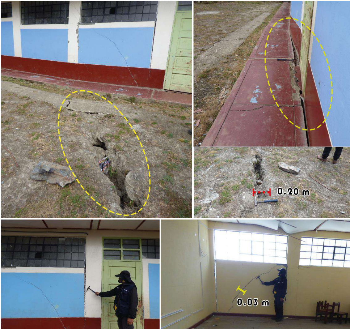
Figura 21: Evidencias de la afectación de la Institución Educativa N°33008, tanto en paredes como en el piso; nótese además la deformación que presenta el suelo debido a la reactivación del deslizamiento, la cual es señalada en líneas entrecortadas amarillas. Coordenadas referenciales UTM WGS-84, 18S E:319711, N:8945205.
