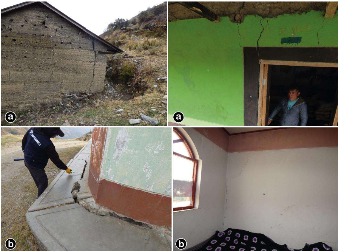
Figura 30: a. Afectaciones en viviendas, con grietas en paredes de 0.01 a 0.02 m. b. Afectaciones en el local comunal de Sogobamba con grietas de 0.04 a 0.10 m en su estructura.
