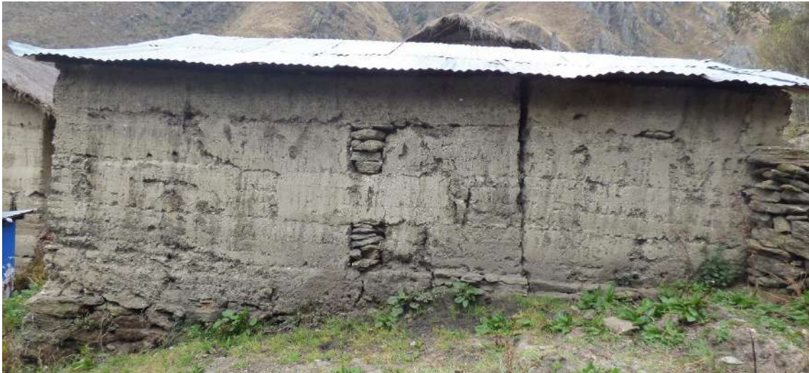
Fotografía 3: Vivienda afectada debido a la reactivación del deslizamiento D3. Coordenadas referenciales UTM WGS-84, 18S E:319754, N:8945202.
