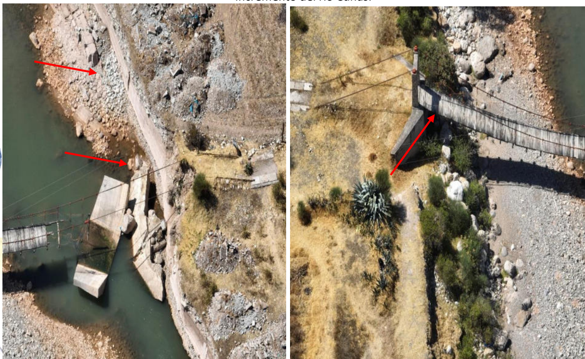
Imagen N° 36: Se evidencia un puente colgante colapsado a consecuencia del incremento del río Cunas.
