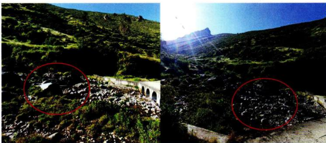
Figura N° 5: Quebrada Caurajin colmatada con rocas de gran tamaño
