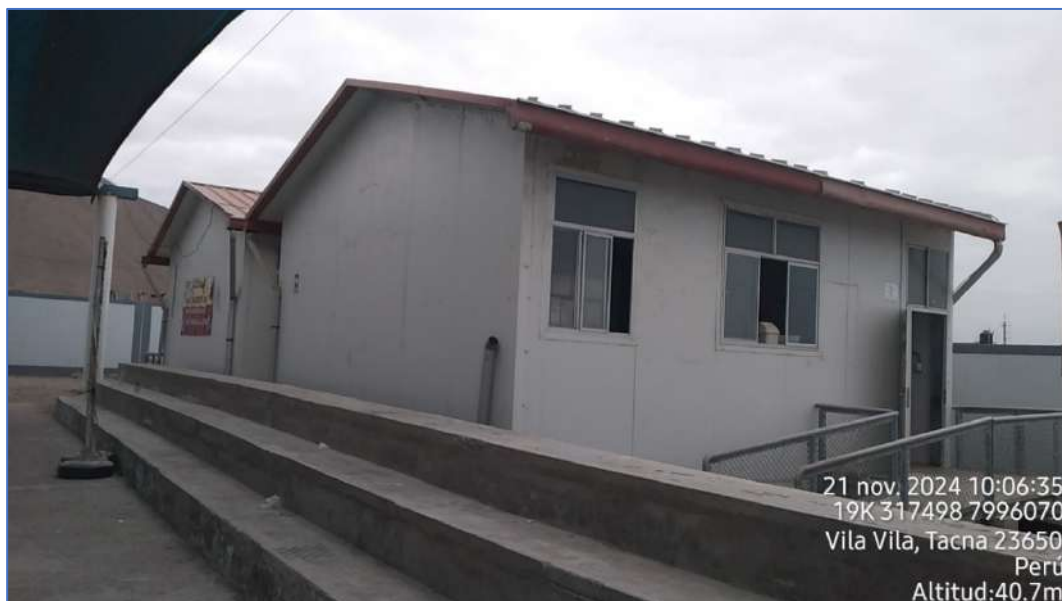
Fotografía 8 - Modulo provisional de paneles tipo sándwich, aulas de 1ro y 3ro de secundaria
