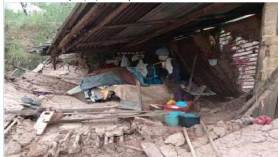
Foto Nº 11: Vientos fuertes La Brisas-Picota, 1 vivienda inhabitable (6/3/2020)
