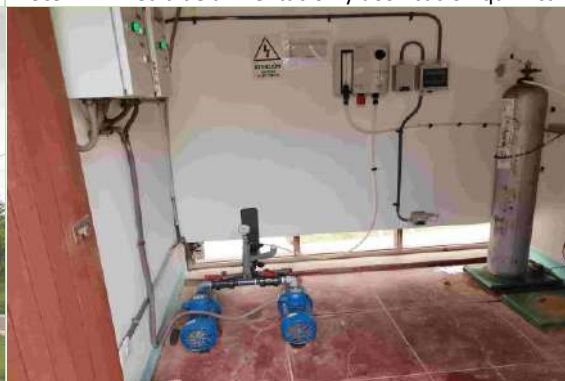
Foto N° 22: Sala de alimentación y dosificación química
