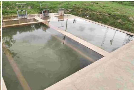
Foto N° 24: Pozas de sedimentación o decantadores
