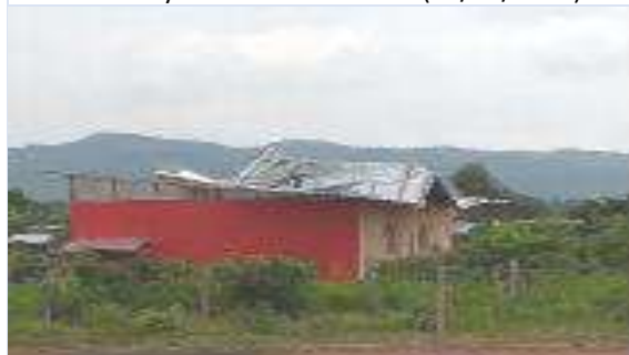
Foto N° 15: Vientos fuertes Picota, 14 viviendas inhabitables y 4 vivienda afectada (13/10/2020)
