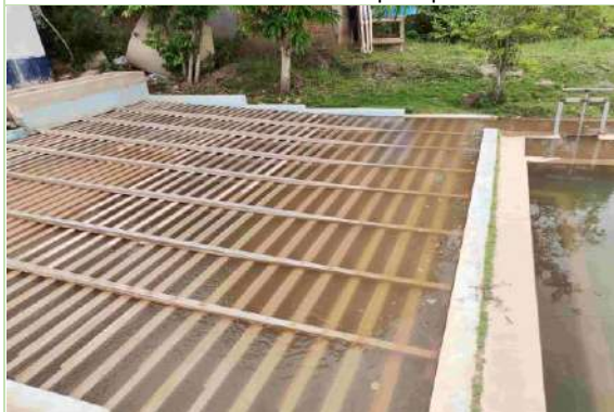
Foto N° 23: Sistema de filtrado para potabilización
