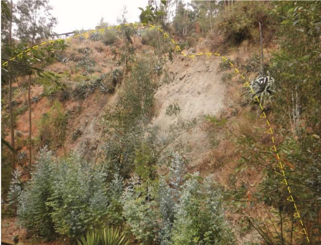
Figura 19. Deslizamiento rotacional antiguo, ubicado en la margen izquierda de la quebrada Quillipururi, cubierta por vegetación.
