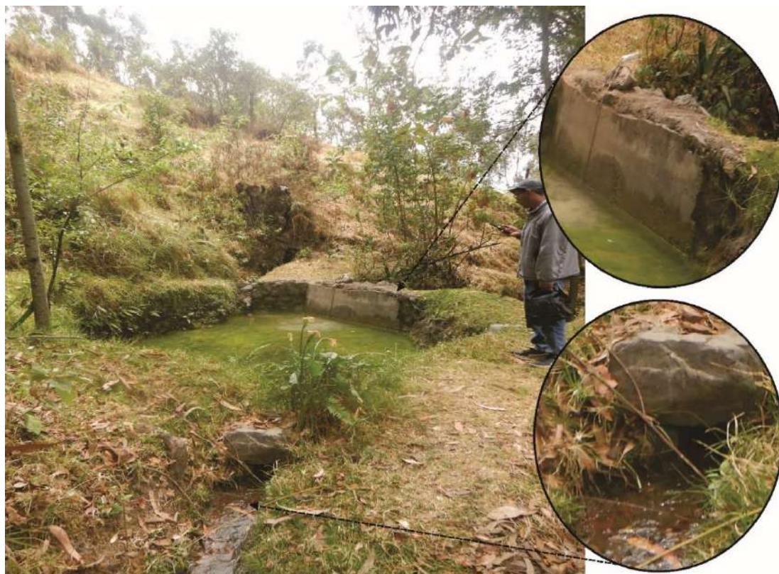
Figura 20. Vista del reservorio rustico, ubicado en la margen izquierda de la quebrada Quillipururi, el canal que deriva el agua hacia el reservorio rustico, que tampoco cuenta con revestimiento.
