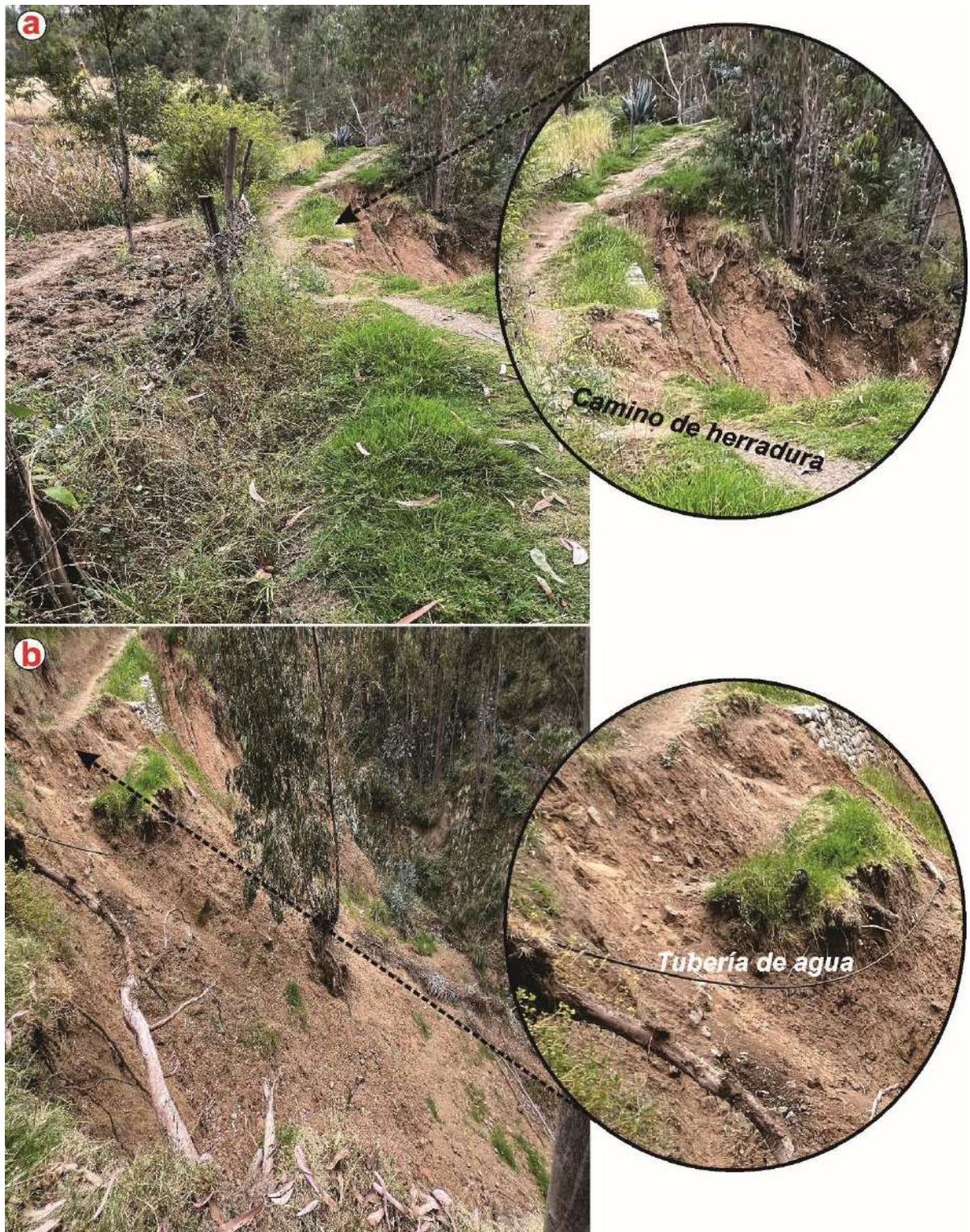
Figura 25. Se observa (a) La escarpa del deslizamiento, algunos árboles caídos y otros por caer; b) Camino de herradura afectado por el deslizamiento, en un tramo de 10 m, así como tubería de agua potable, el mismo que pasaba por un costado del camino de herradura, actualmente se encuentra colgado.
