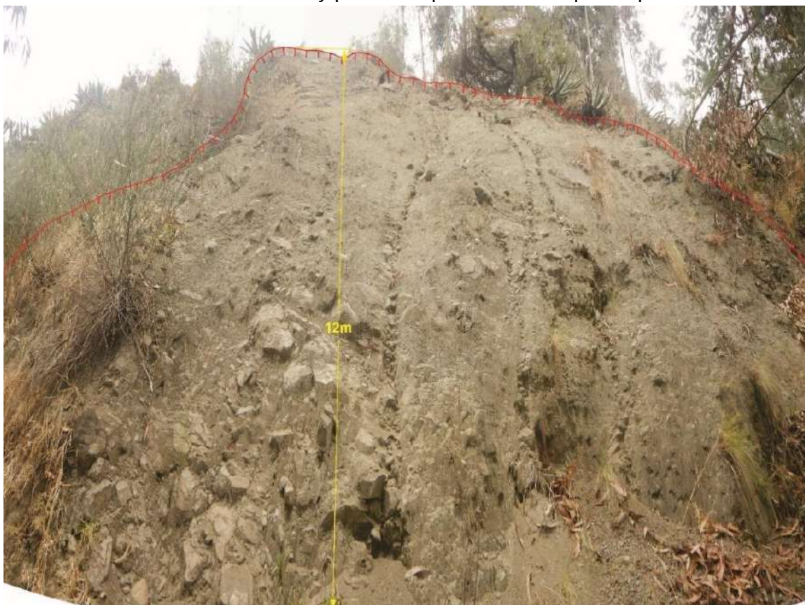
Figura 18. Vista frontal del derrumbe, margen derecha de la quebrada Quillipururi.
