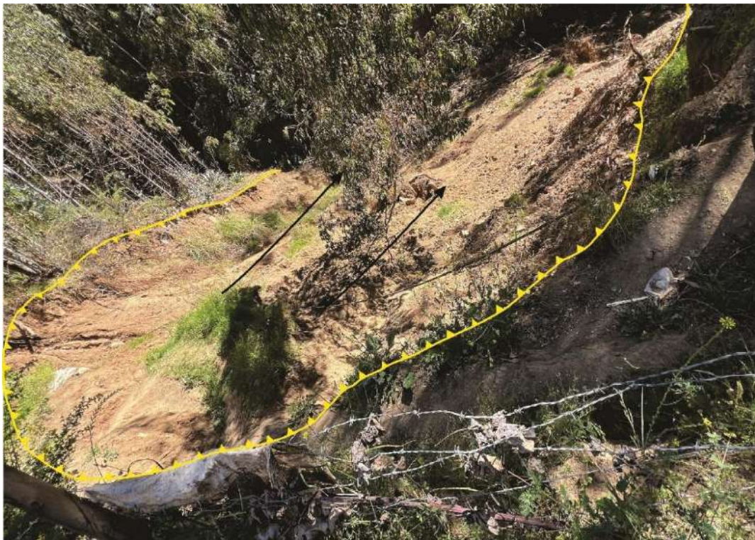
Figura 24. Vista al norte, donde se observó un deslizamiento rotacional reactivo, el cual afectó varios árboles de eucalipto, el material se depositó en la quebrada.
