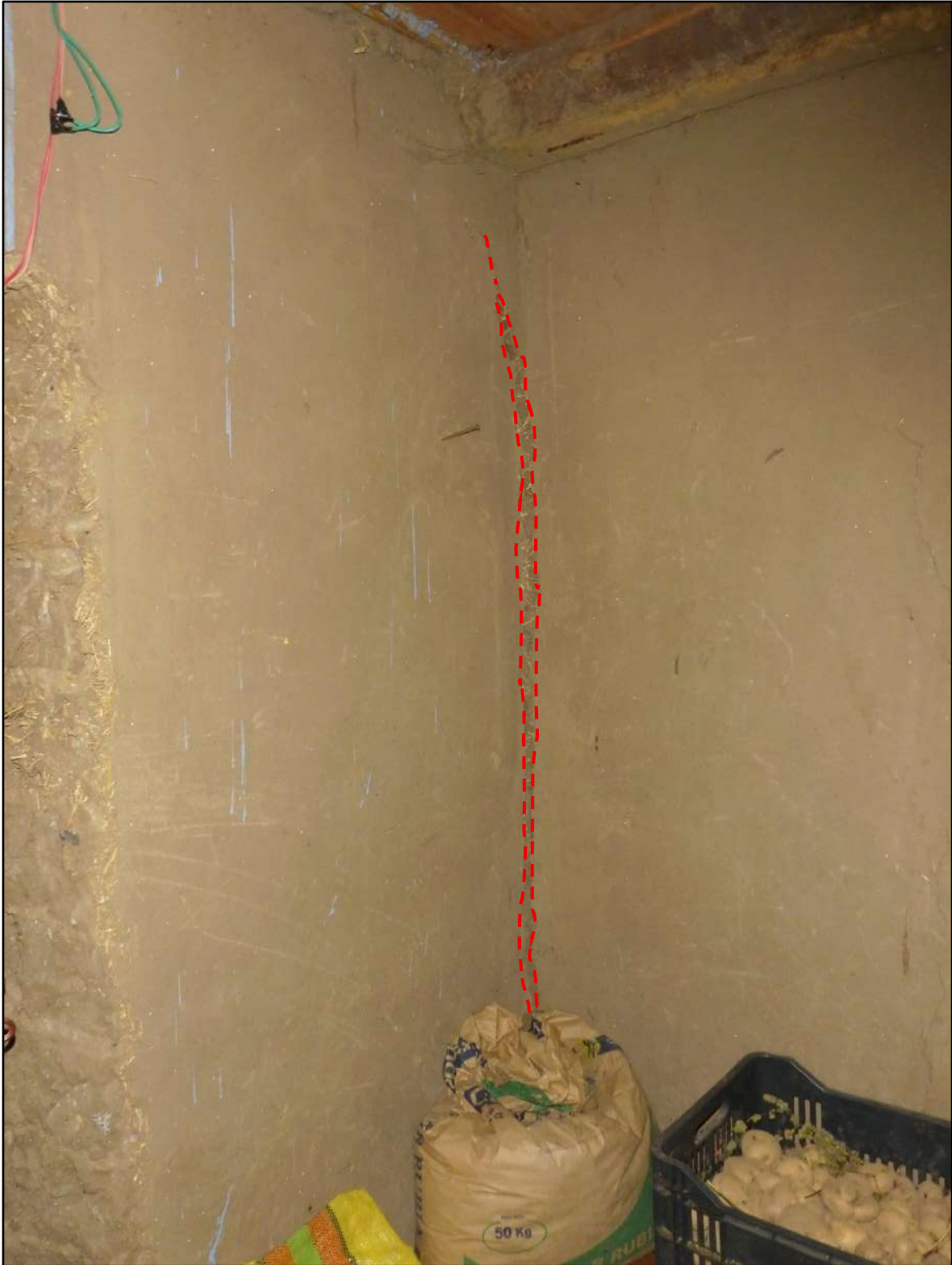
Figura 14. Grietas en las paredes de las viviendas de la comunidad campesina de Pfacó.
