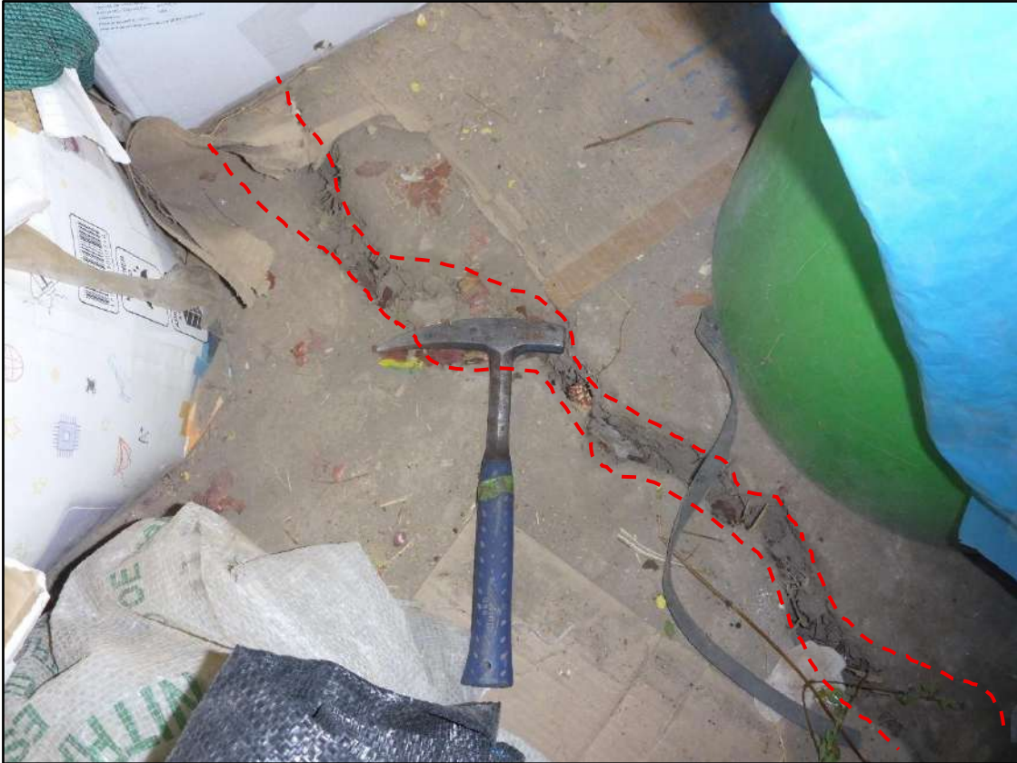
Figura 12. Grietas en los pisos de las viviendas en la comunidad campesina de Pfacó.
