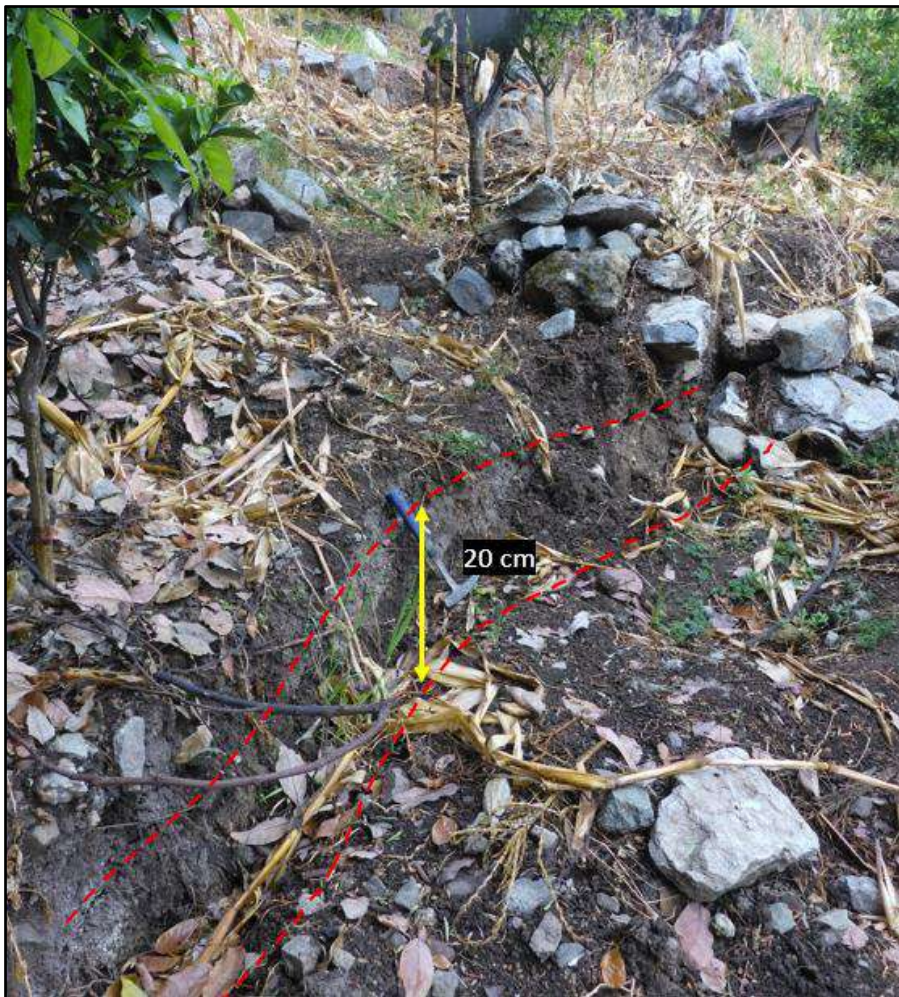
Figura 11. Grietas en la zona agrícola de la comunidad campesina de Pfacó.
