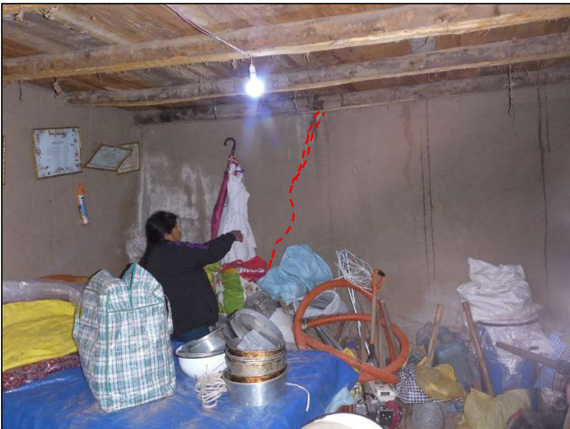
Figura 13. Grietas en las paredes de las viviendas la la comunidad campesina de Pfacó.
