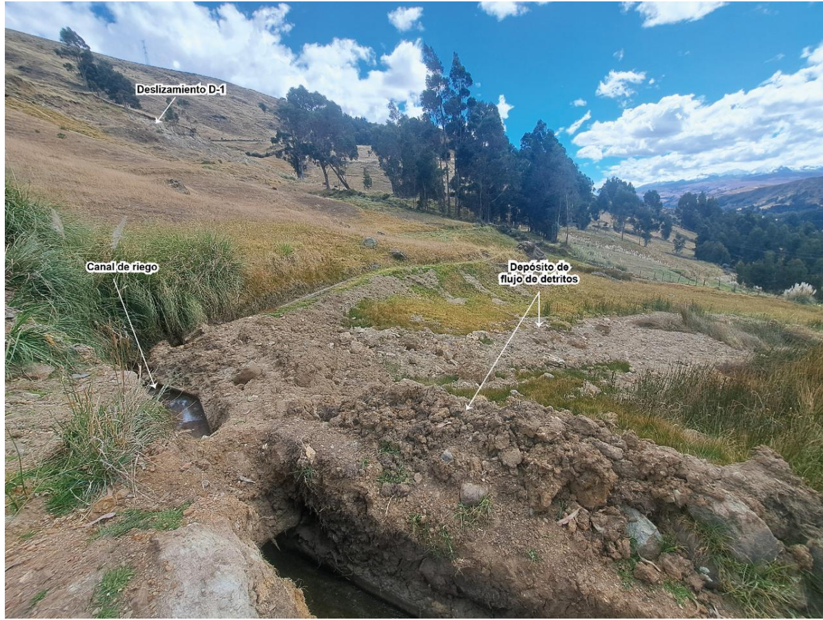
Figura 20. Vista de depósito de flujo de detritos que en su momento obstruyó 8m del canal de riego de concreto, cuyo material fue removido por los vecinos con el fin de liberar el cauce del canal.
