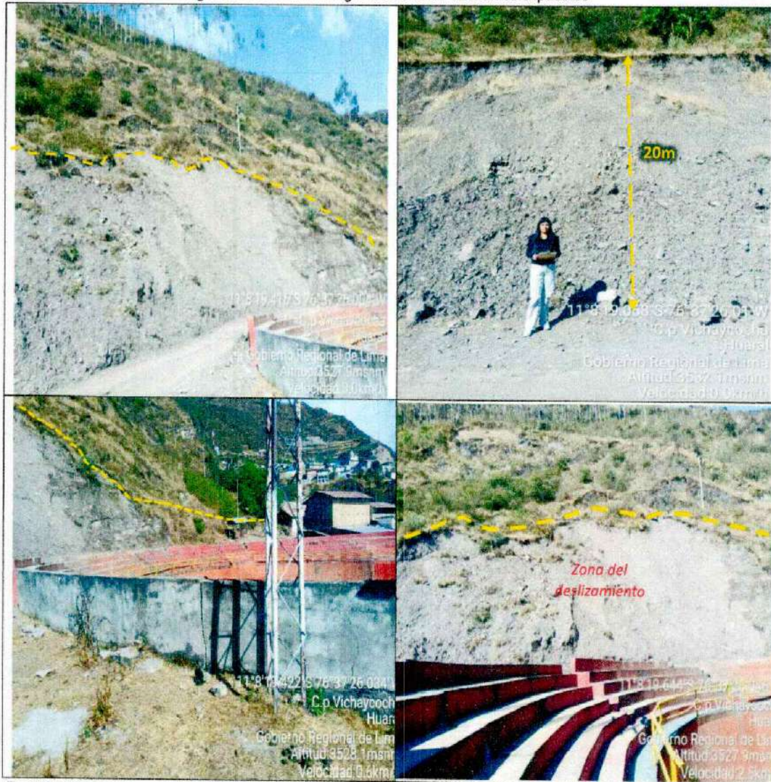
Figura N° 29. Panel fotográfico de la los elementos expuestos
