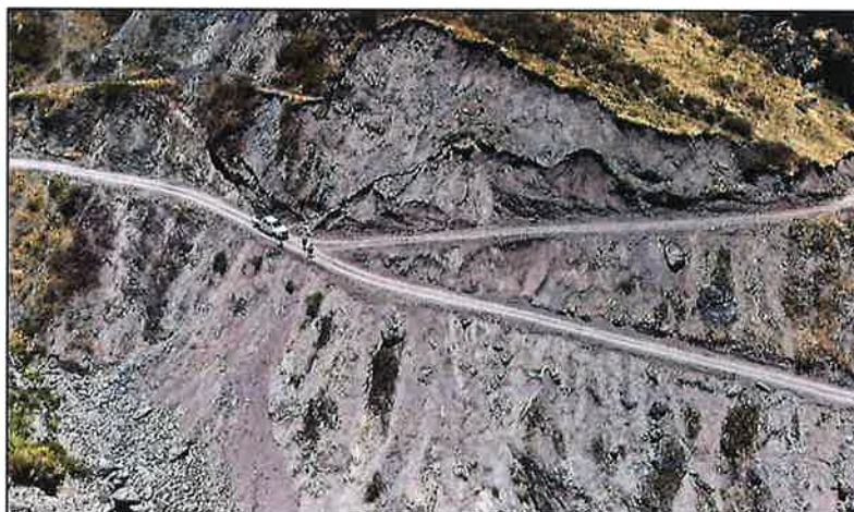
Fotografía 5. Deslizamiento en el Sector de Chilca Chilca
