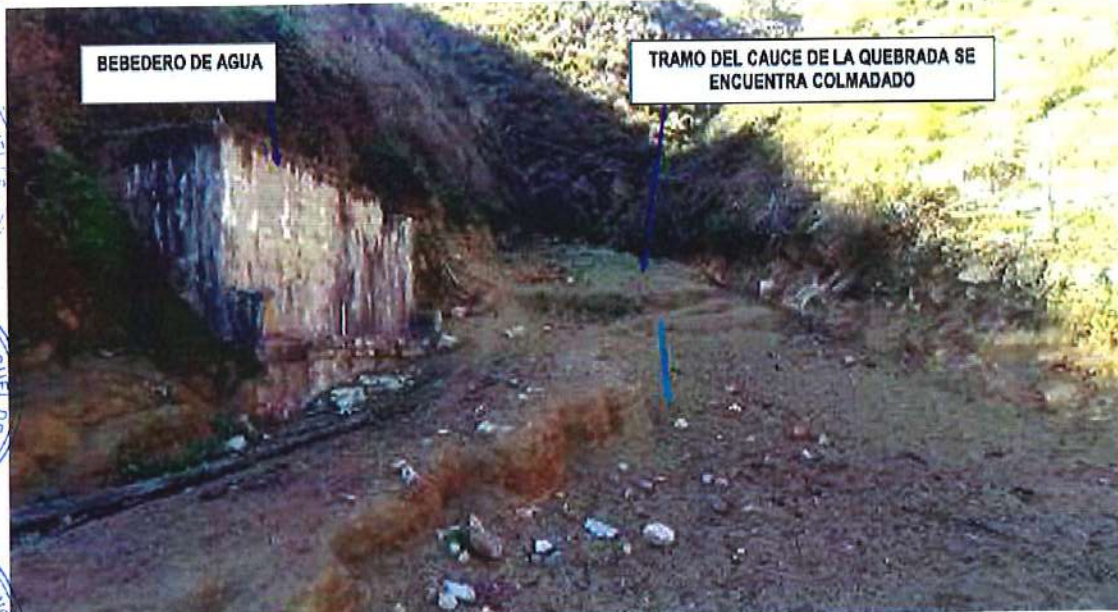
Figura N° 31. Zona crítica de la Quebrada Chancar presenta flujo de detritos y erosión fluvial
