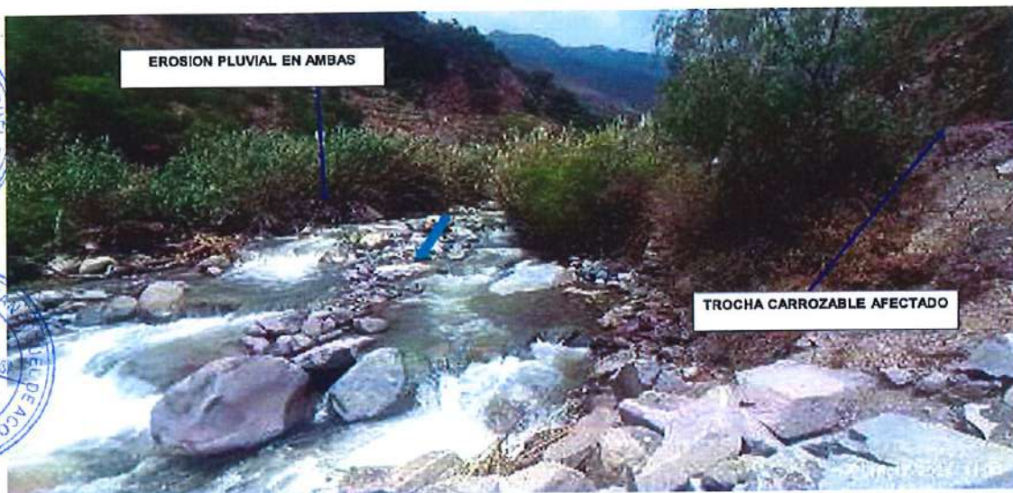
Figura N° 41. Zona crítica del puente Oquendo presenta inundación y erosión fluvial
