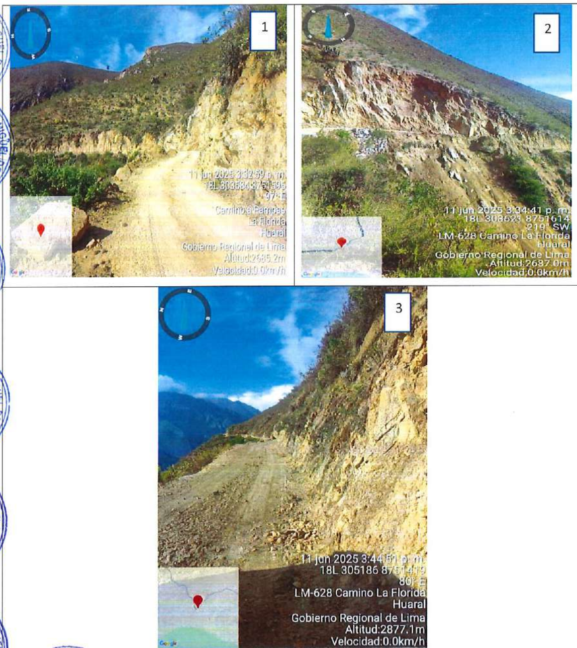
Figura N° 27. Zona critica sector Shanquillipa, presenta deslizamiento. (1) se observa Tramo 1, (2) se observa el segundo tramo expuesto.
