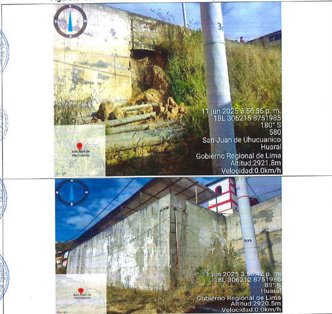
Figura N° 39. Zona critica mirador de Uchucuanico presenta deslizamiento.
