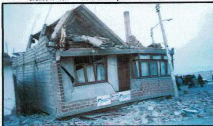
Gráfico N° 13. Vivienda colapsada en su totalidad
