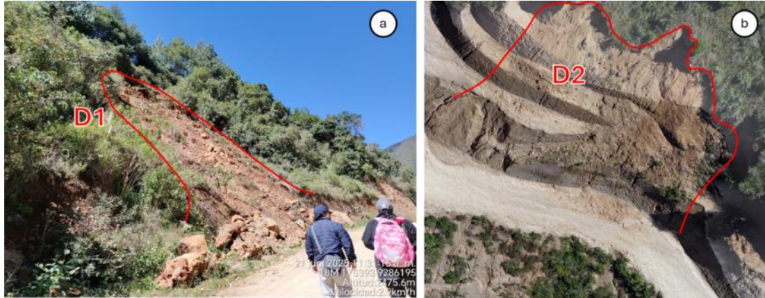
Figura 11. Derrumbes (línea roja).
