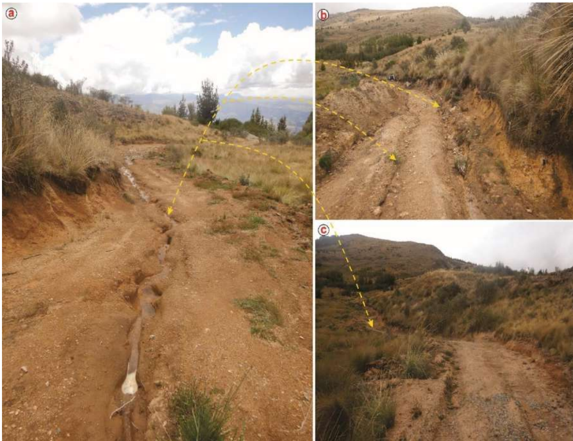
Figura 37. En parte de la trocha carrozable se observó procesos de erosión de ladera de tipo surco, presenta anchos menores a 30 cm y profundidades variables de 10 a 15 cm
