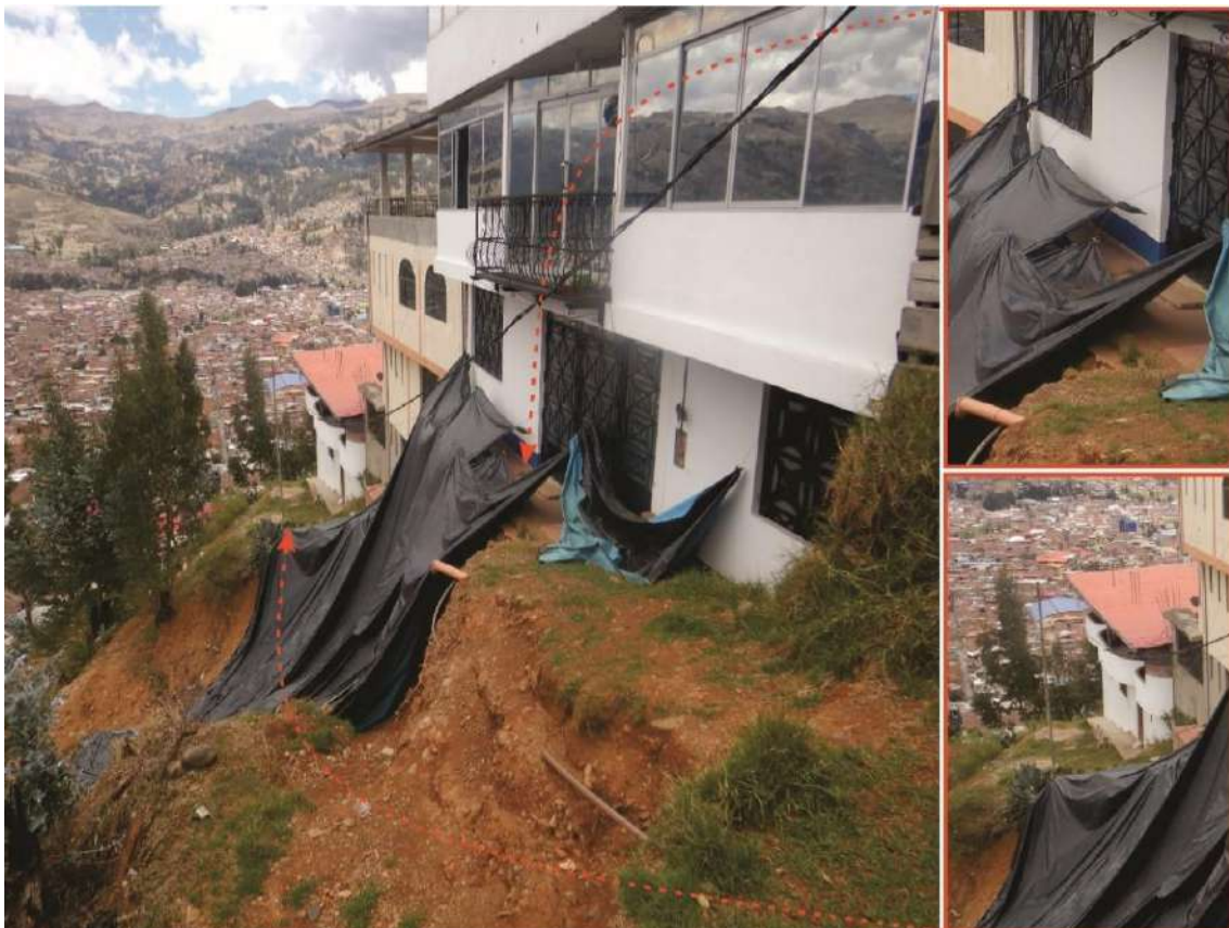
Figura 24. Se observó que los propietarios de las viviendas instalaron plásticos con el objetivo de que el terreno no sea lavado producto de la lluvia, así mismo se observó que la tubería de agua potable y desagüe fueron afectados por el deslizamiento.
