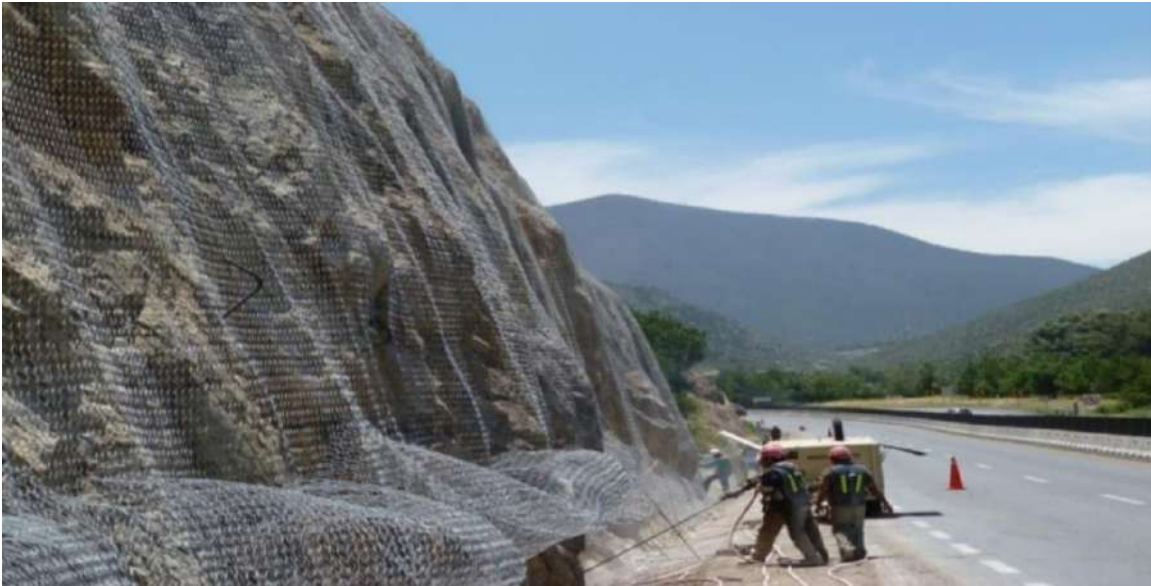
Fotografía 1. Mallas de protección con anclajes para caída de rocas o derrumbes tanto en detritos como roca alterada.
