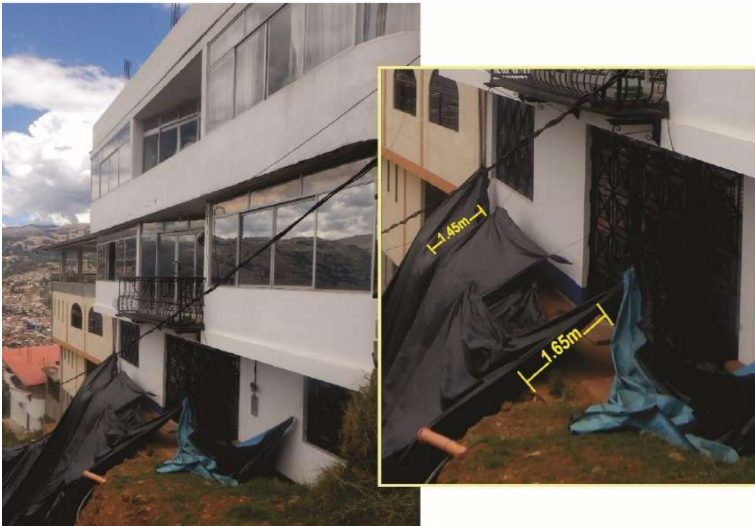
Figura 22. Viviendas ubicadas muy próximas a la escarpa del deslizamiento, las cuales se encuentran actualmente habitadas.
