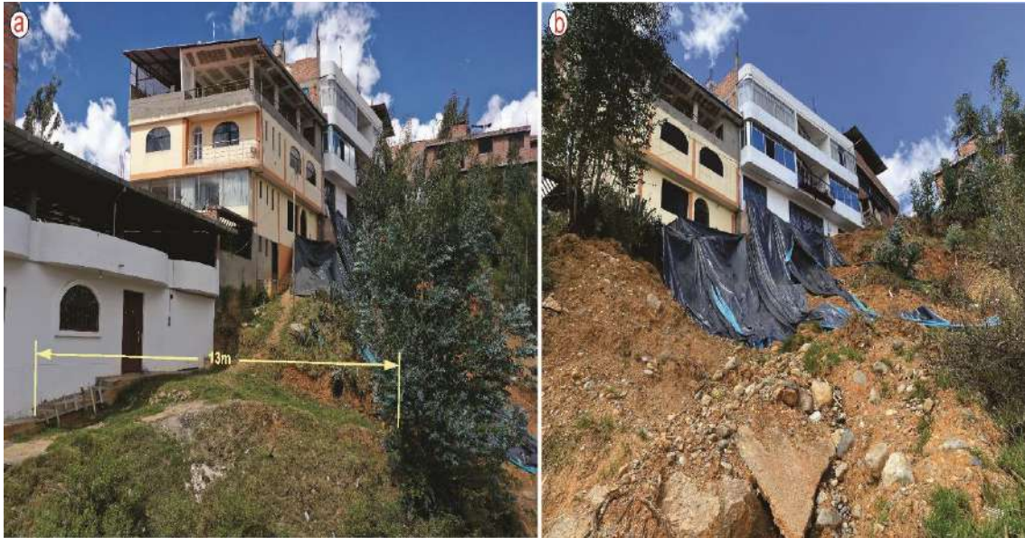
Figura 23. Se observa a) viviendas ubicadas próximo a la escarpa del deslizamiento y b) algunos árboles colapsaron y otras se encuentran en la escarpa.
