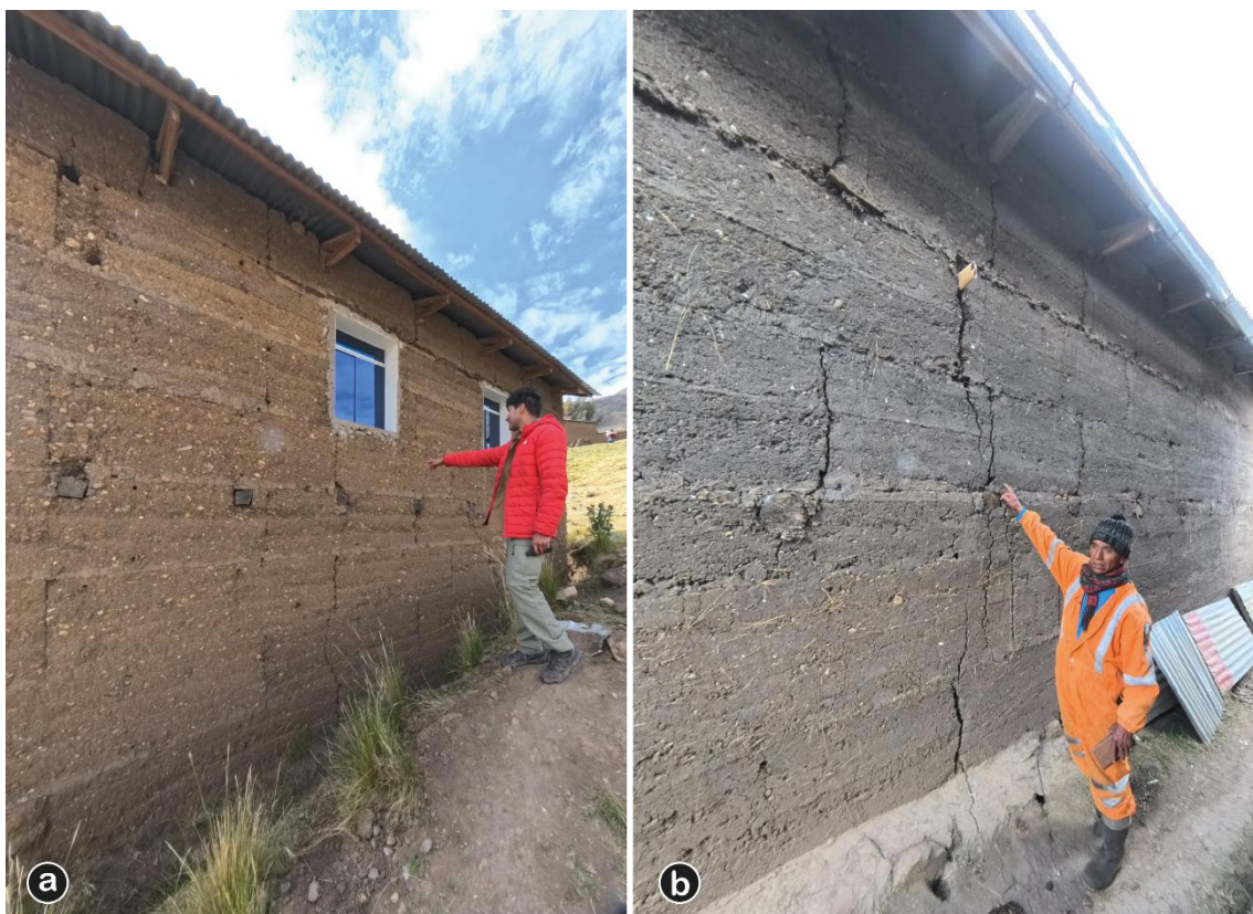
Figura 15. Afectación de viviendas del sector Chochapata. a. Grietas en paredes de vivienda con aberturas de 3.0 cm y longitudes de 2.0 a 2.5 m. Coordenadas referenciales UTM WGS-84, 18S: E: 518755; N: 8555878. b. Grietas en pared de vivienda con aberturas entre 2.0 a 5.0 cm. Coordenadas referenciales UTM WGS-84, 18S: E: 518788; N: 8555920.
