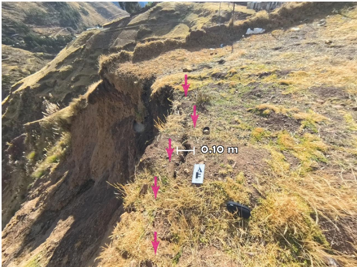
Figura 9. Grietas de tracción con aberturas de 0.10 m, ubicadas por encima del escarpe principal. Coordenadas referenciales UTM WGS-84, 18S: E: 518771; N: 855956.
