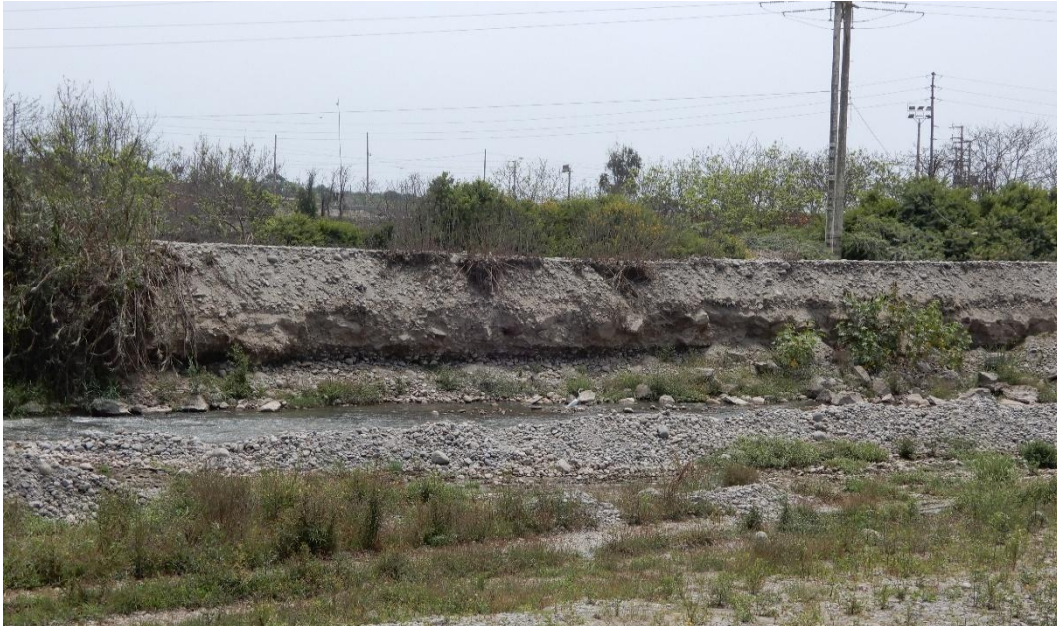
Fotografía 3. Vista del socavamiento generado en la margen izquierda del río Chancay. Este proceso afecta la terraza aluvial compuesto por bloques subangulosos, gravas, arenas, limos y arcillas.
