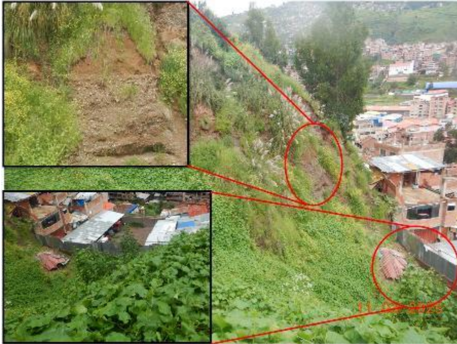
Figura 7: En la cabecera de la cárcava se aprecia la construcción de un garaje sobre el canal de la cárcava, además se evidencian procesos de derrumbe en las márgenes, generando el colapso de materiales que se acumulan en el fondo del canal erosivo.
