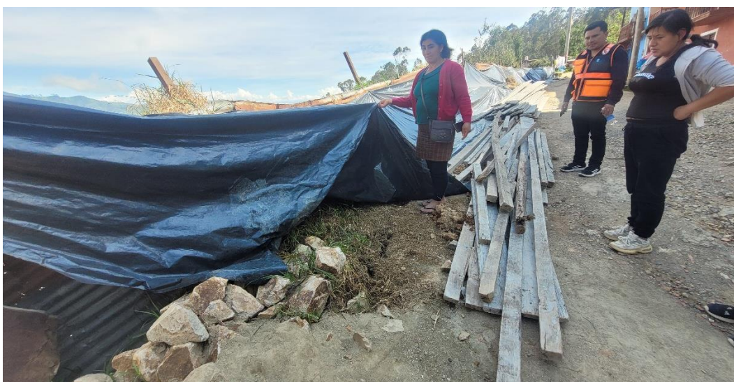
Fotografía 5. La población a colocado plásticos sobre la zona afectada, para evitar el ingreso de agua, en las grietas identificadas.
