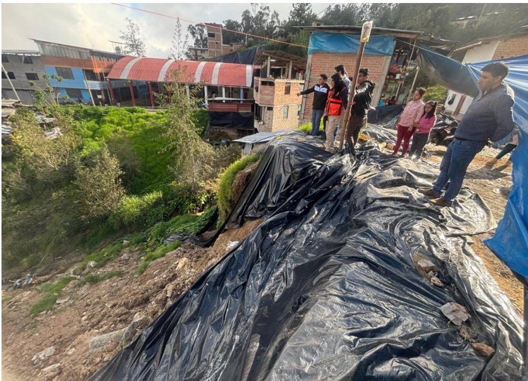
Fotografía 2. Zona de arranque cubierta con plásticos para evitar que ingrese agua de lluvia a la zona derrumbada.
