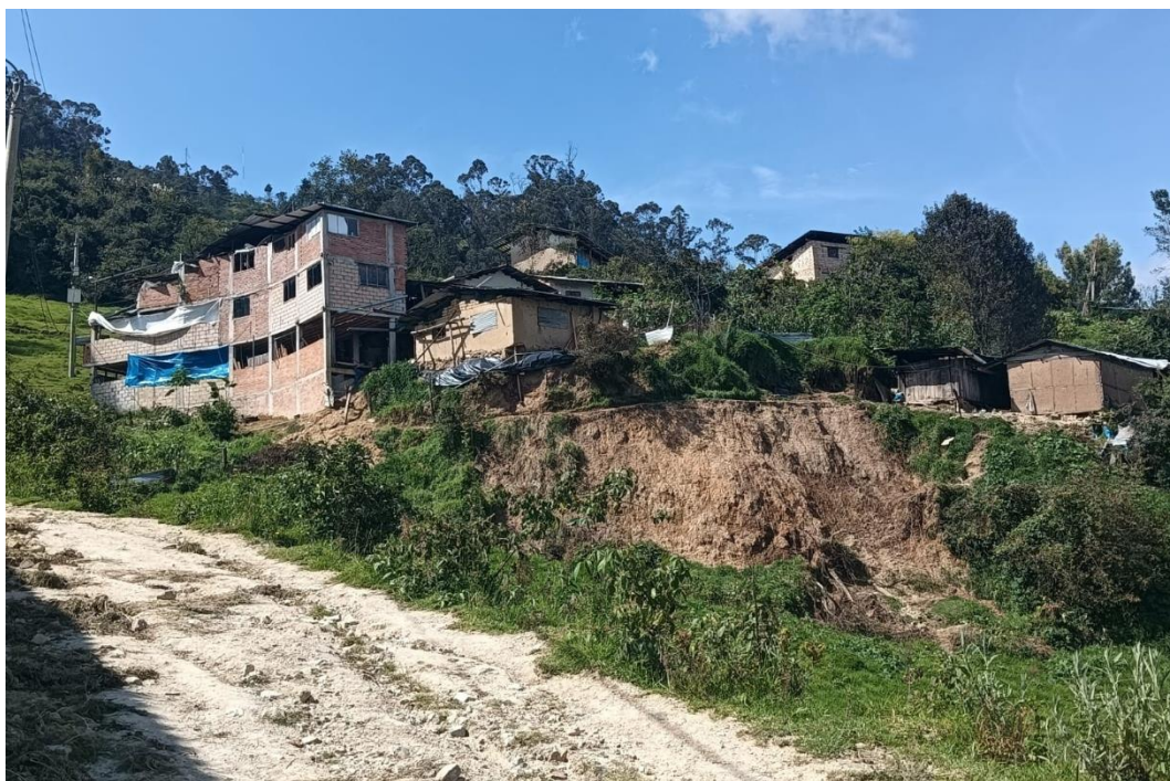
Fotografía 3. Viviendas expuestas a la zona de derrumbe (D2).
