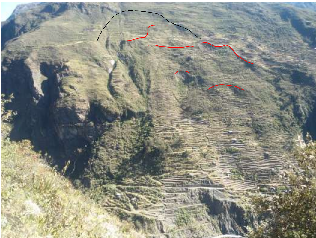
Foto 09: Vista panorámica del cerro Ccatasuyo. a) escarpa de caída de rocas ocurrido el 27 de enero 2006 que afectó 5 viviendas del barrio Luis Ron; b) Macizo rocoso muy fracturado; c) derrumbes ocurrido en abril del 2012
