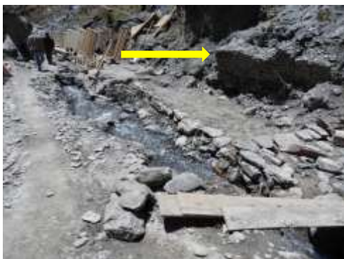
Foto 06 Vista en la quebrada Jilari se observa vuelco de muros (pircas) por derrumbes.
