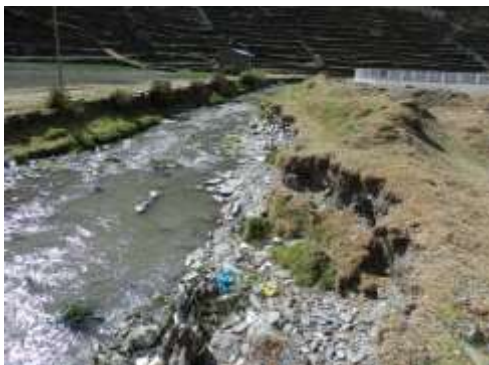
Foto 08 Cauce afectado por erosión fluvial.
