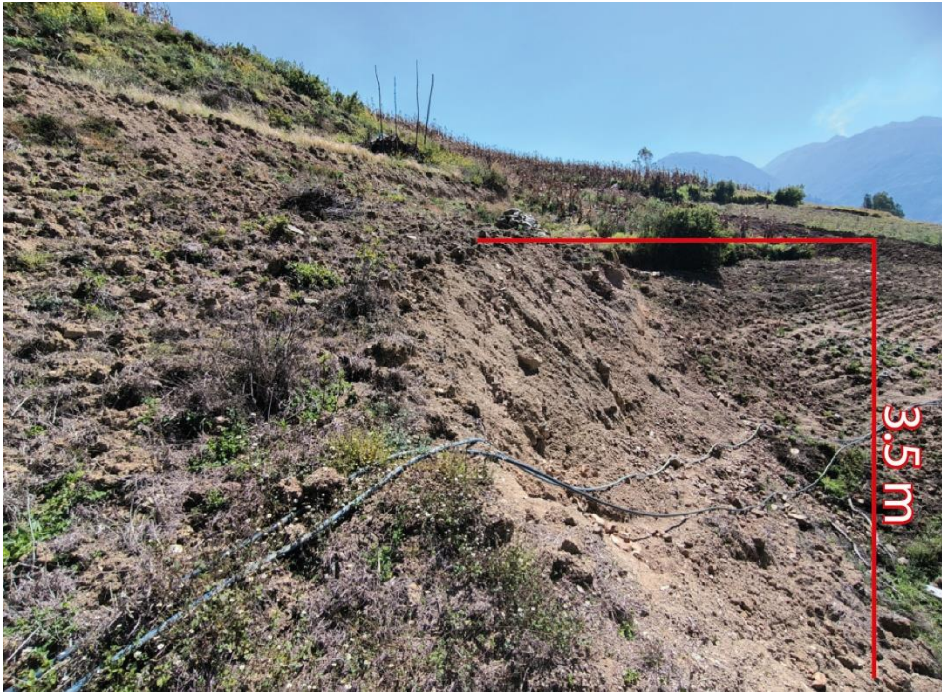
Figura 6 . Escarpe principal del deslizamiento de 3.5 de altura con actividad retrograda.
