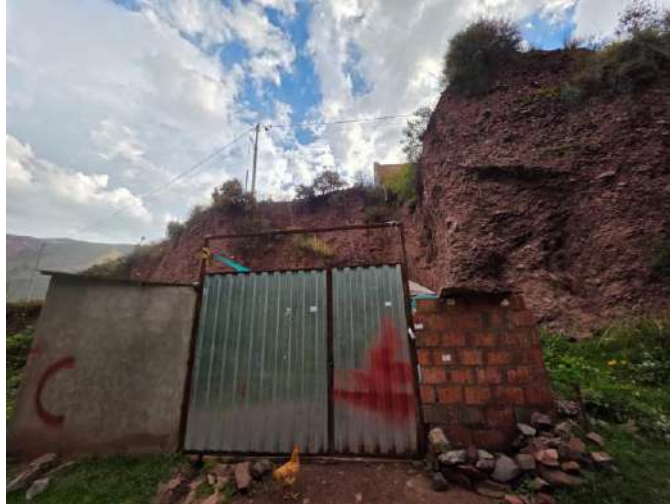
FOTOGRAFÍA 28: VIVIENDA UBICADA EN EL CAUCE DE LA QUEBRADA CONDEBAMBA AL PIE DE UN TALUD INESTABLE.
