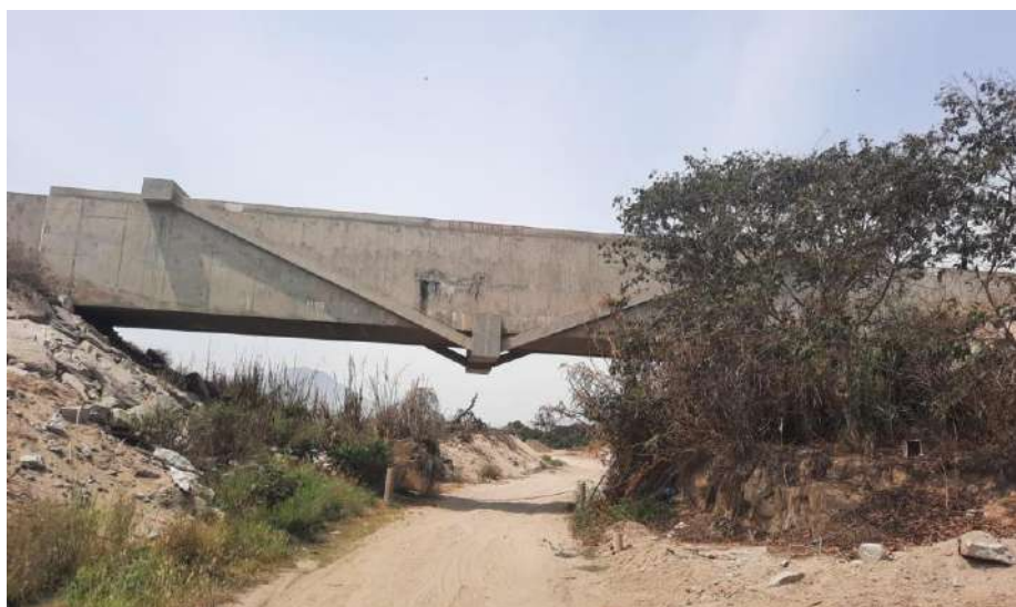
3.- Puente del canal Chincetas, cuyas bases han sido socavadas y ante una venida de agua en la quebrada se puede asentar y colapsar, generando un problema de desabastecimiento de agua en el distrito
