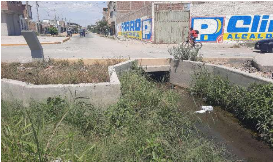
2.- Salida del canal de regadío del AAHH, es un canal pequeño que no soportaría un volumen de venida de agua ante un evento natural
