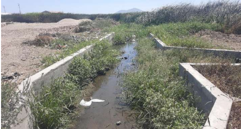
1.- Canal de desfogó del AAHH colmatado, falta de limpieza y mantenimiento
