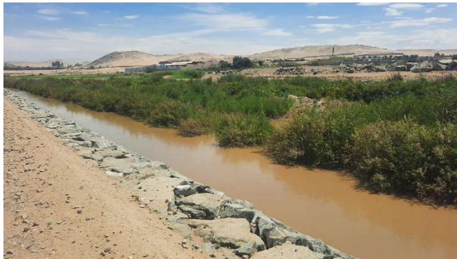
3.- Vista con respecto al AAHH Golfo Pérsico y 1ro de Mayo, la descolmatación no se ha realizado a pesar que en lugar se tiene una curva y representa un peligro latente
