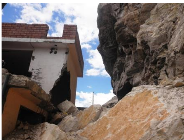
Foto 8, Casa afectada por el deslizamiento del bloques en el AAHH Victoria Perú Coordenada (8725282-399723)
