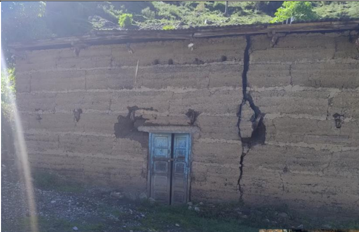
Viviendas con fisuras en mal estado de conservación.
