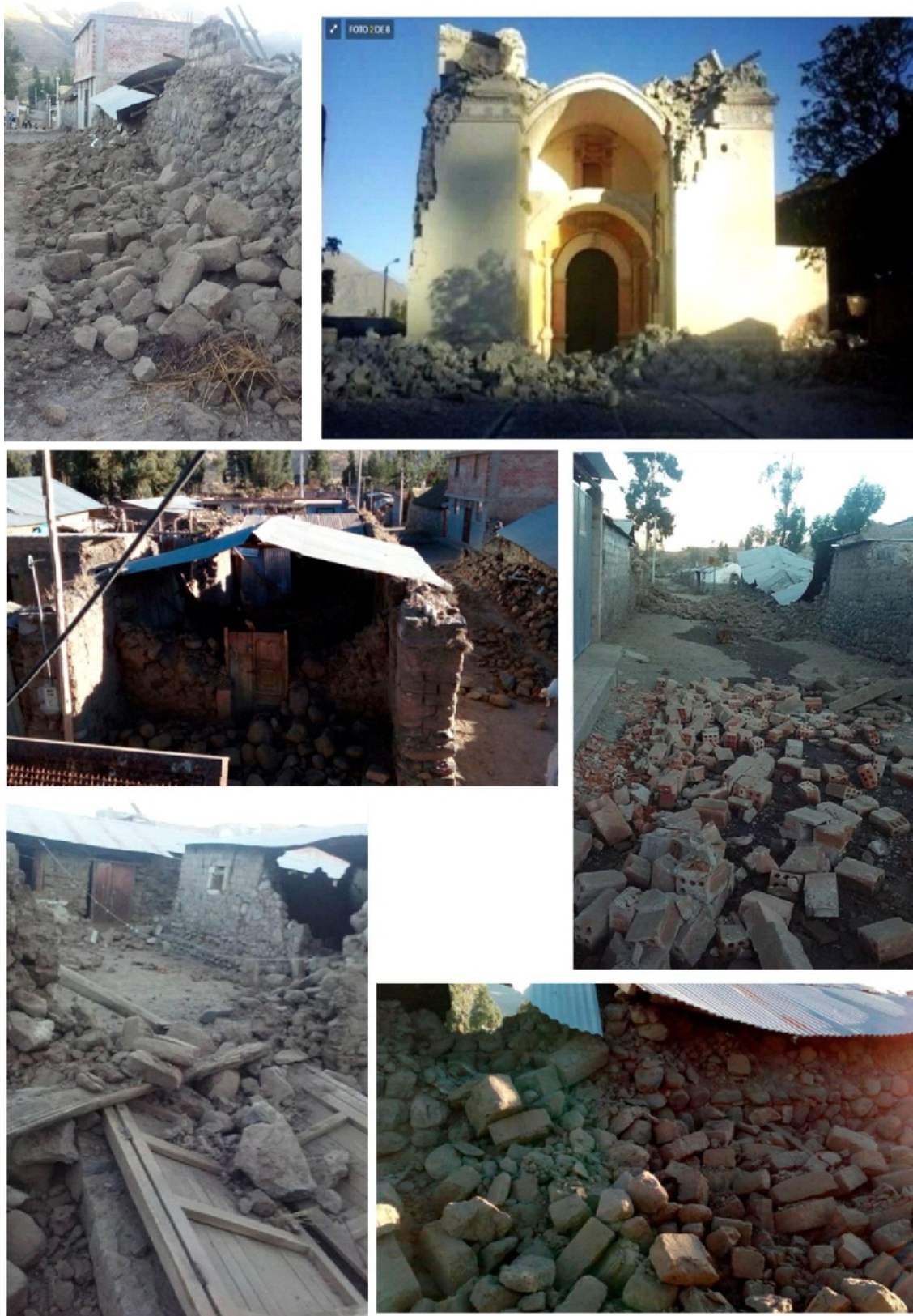
Figura 6. Imágenes de diversas viviendas Ichupampa, Yanque y Achoma construidas con adobe, sillar, piedras y ladrillo pandereta que colapsaron por la fuerte intensidad de sacudimiento del suelo debido al sismo de Ichupampa (fuentes RPP y Facebook valle del Colca).
