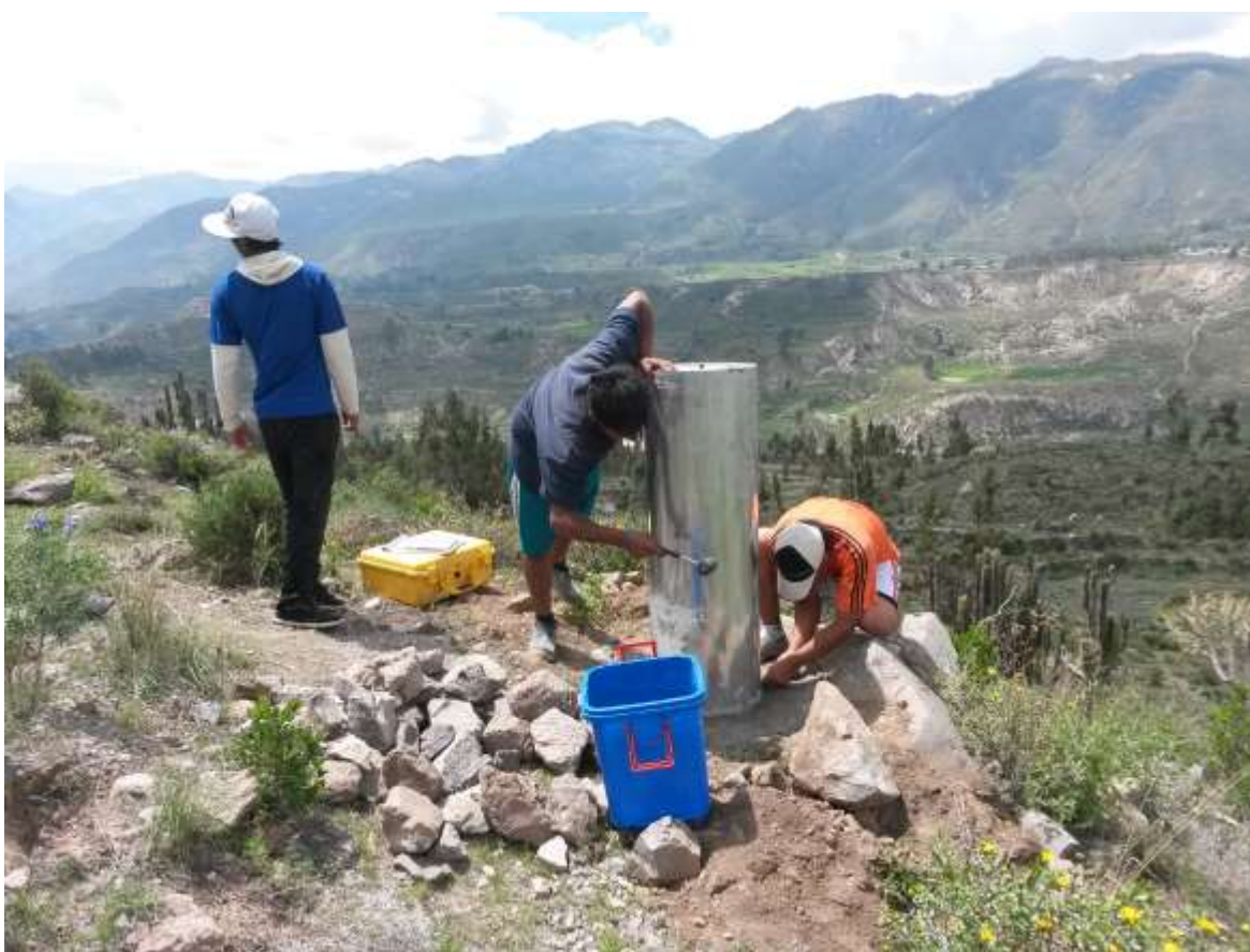
Figura 2. Construcción de las bases de concreto para la instalación del escáner LiDAR.
