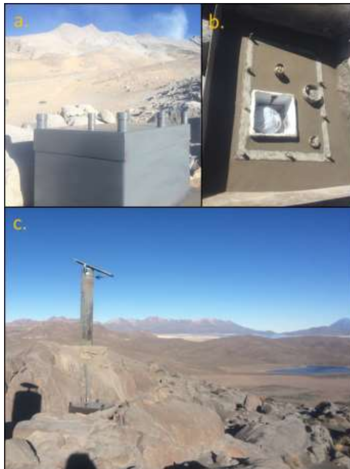
Figura 2.1.3 Ubicación IN SITU de algunas de las estaciones sísmicas que conformaron la Red de Monitoreo Sísmico en el volcán Ubinas durante el año 2015. a. Caja de seguridad; b. ubicación de sensores sísmicos dentro de las cajas de seguridad; c. Pilares de cemento para fijar paneles solares, GPS y radio de transmisión.
