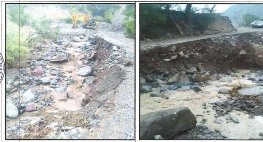
Figura N° 30. Daños en el sector Chingos - Pamplona
