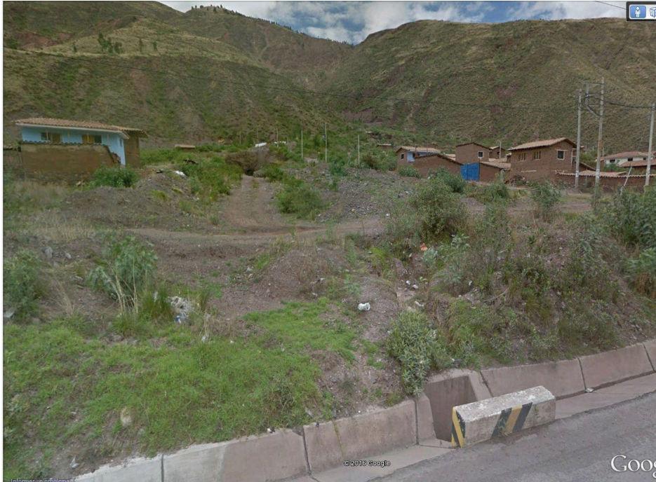
Foto 3. Vista de la quebrada Sacrahuaycco aguas arriba desde la carretera Cusco-Sicuani; en donde se puede observar la falta de definición y profundización del cauce principal de la quebrada, esta atraviesa la vía por una alcantarilla que también es posible observar en el extremo inferior derecho de la imagen. En la cuenca alta se puede observar los derrumbes activos.
