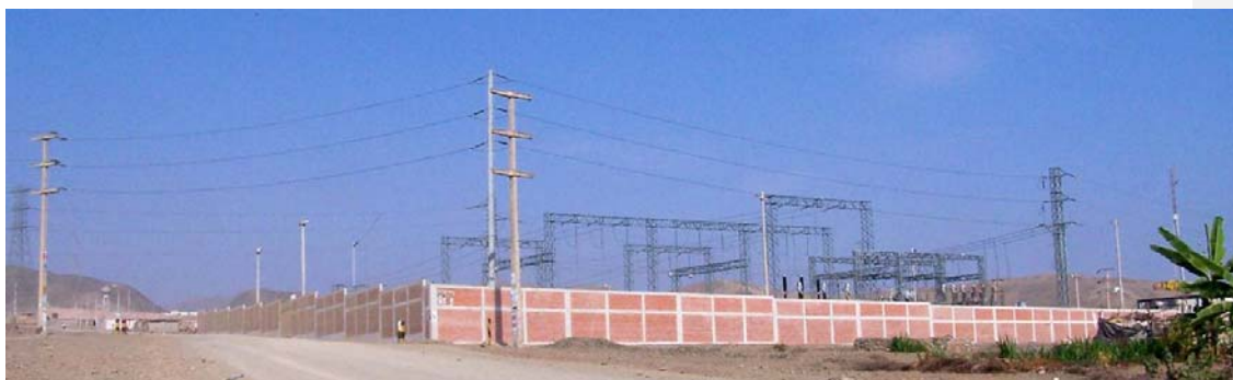
Subestación eléctrica La Cantera
