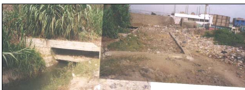
Canal María Angola en su transición de canal cubierto a un canal abierto sin revestimiento. Se observa gran acumulación de basura en la margen izquierda del canal.
