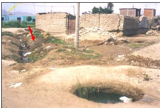
Canal de drenaje en la Asociación de Vivienda Villarreal, se observa además el hoyo de buzón del sistema de alcantarillado en construcción (obra inconclusa).
