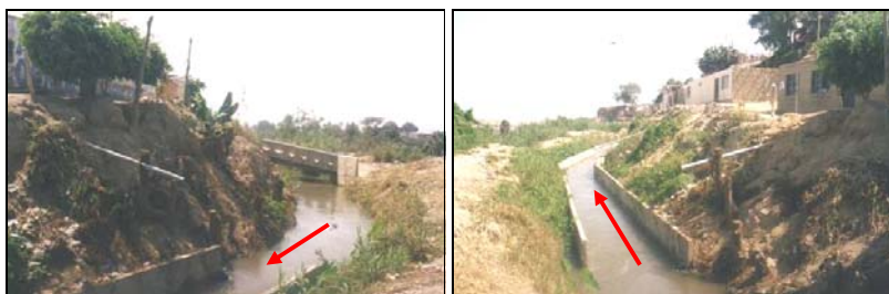
Canal San Miguel, en la margen derecha se observan viviendas que arrojan sus desagües al canal y hacia la margen izquierda está contenido por un terraplén.
