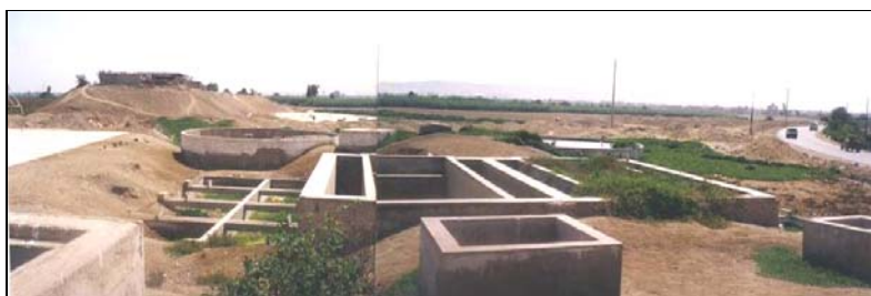
Se observan las dos pozas de tratamiento de aguas servidas de la ciudad de Nuevo Imperial. La poza de la izquierda se encuentra colapsada y no funciona.
