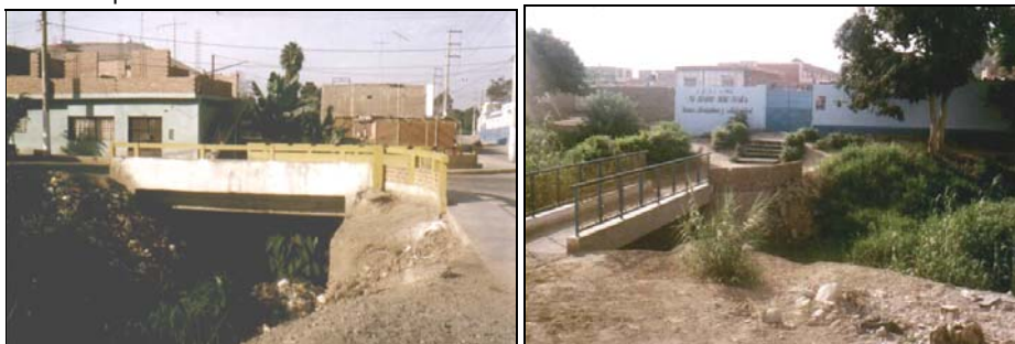
Izquierda. Cruce de la Quebrada Pócoto con la Calle Garro (Puente Garro) en la Ciudad de San Vicente. Derecha. Quebrada Pócoto en su paso por la ciudad de San Vicente.
