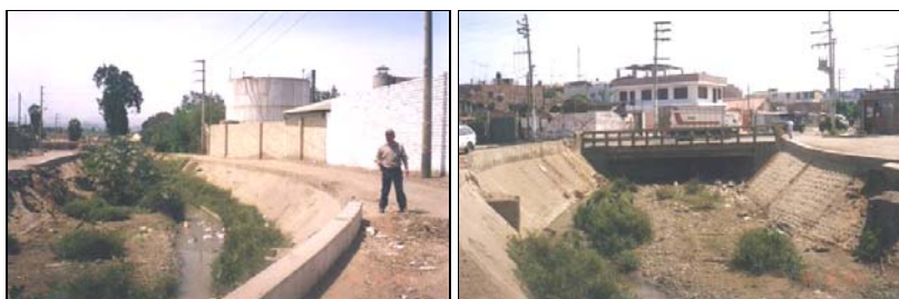
Izquierda. Quebrada Pócoto, a falta de mantenimiento, se observa el fondo colmatado. Derecha, se observa el cruce de la quebrada Pócoto con la Av. José Galvez, con fondo colmatado.
