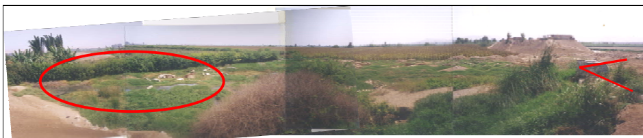
A la derecha con línea roja se indica el tubo emisor desperdiciando aguas servidas, a la izquierda con una elipse se observa charcos de aguas servidas.
