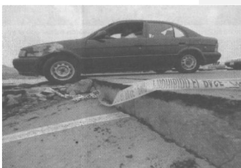
Terremoto del 23 de Junio del 2001 Daños en la carretera Panamericana Sur.
