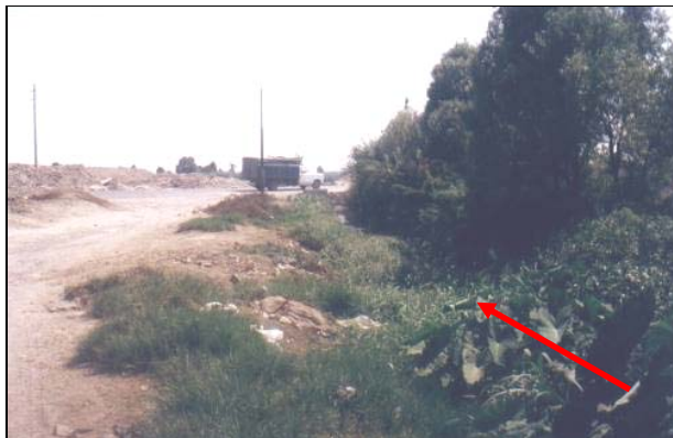
Canal de drenaje superficial en la Asoc. De Viv. Villarreal, se observa el canal lleno de arbustos (carente de mantenimiento).
