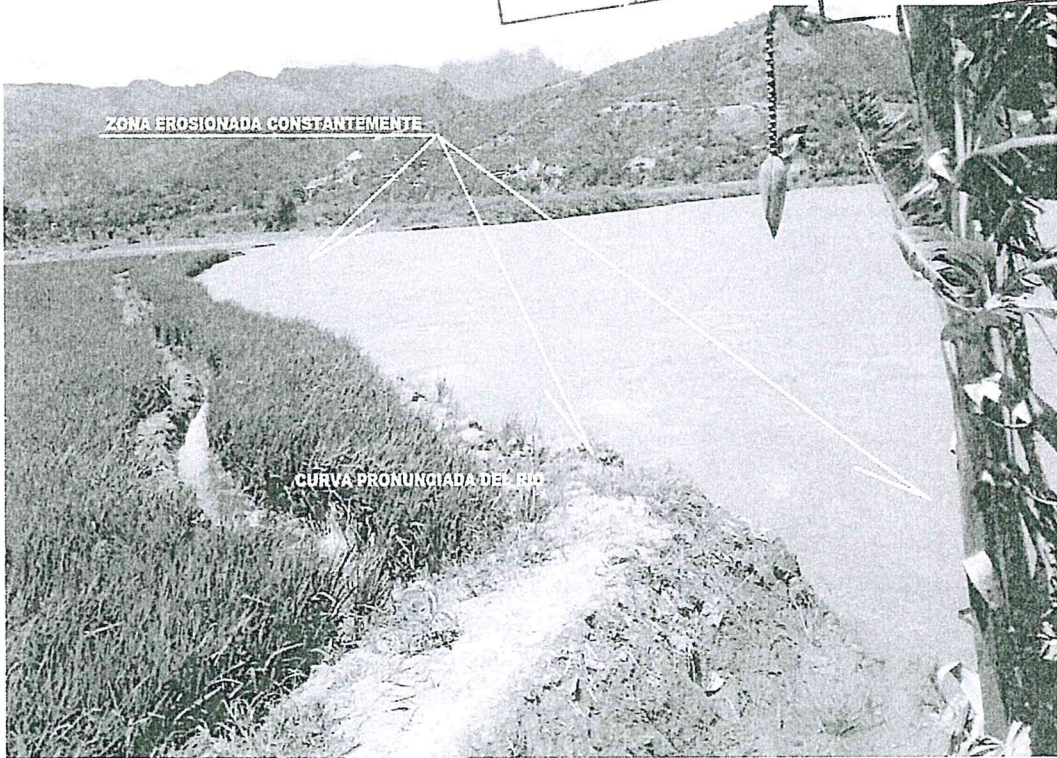
FOTOGRAFIA MUESTRA LA CURVA PRONUNCIADA PRODUCTO DE LA CONSTANTE Y AGRESIVA ERIION QUE SE PRESENTA EN EL PRESENTE TRAMO
