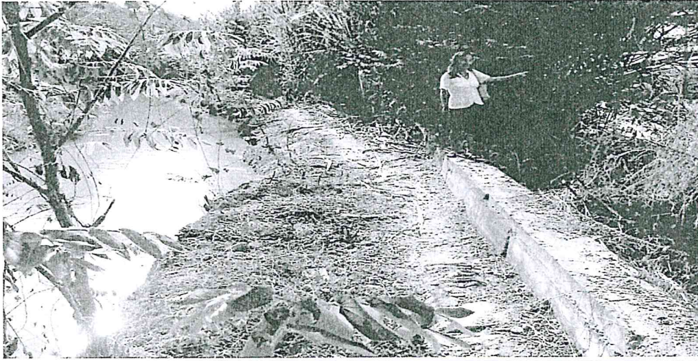
FOTOGRAFIA MUESTRA EL LATENTE PELIGRO EN EL QUE SE ENCUENTRA EL CANAL COMUNAL HUARANGOPAMPA
