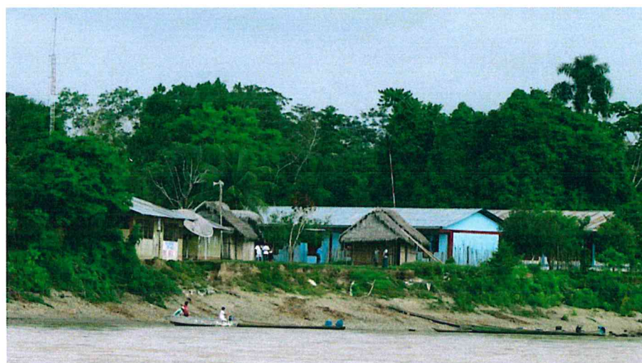
Foto 13 Vista de la Institución Educativa asentado sobre depósito aluvial, conformada de conglomerados y areniscas rojas. De continuar la erosión afectaría los dos pabellones de aulas que se encuentran a 10 m. del borde del cauce de río
