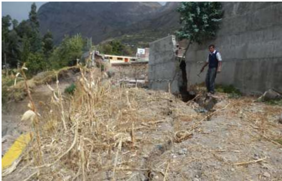
Foto 3. Agrietamiento del terreno ubicado detrás de la escarpa principal.
