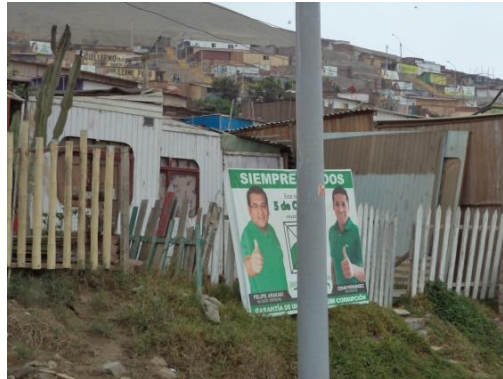
Figura 17. Edificaciones de madera destinadas al uso de vivienda. Mal estado de conservación.
