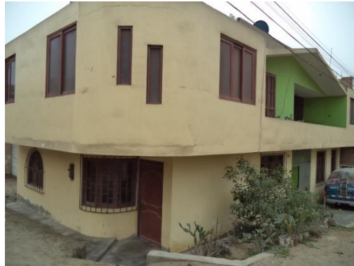
Figura 20. El sistema estructural que predomina es el de mampostería de arcilla con diafragmas rígidos.
