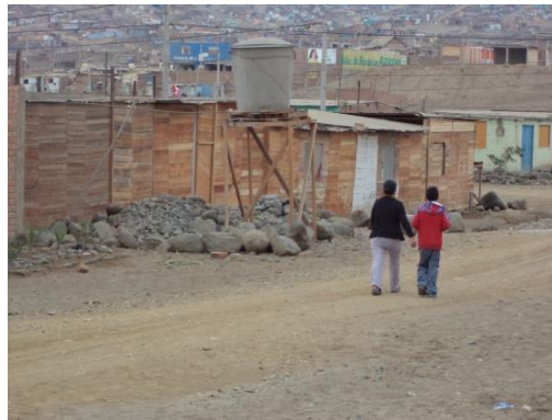
Figura 32. Edificaciones de madera de uso vivienda, en mal estado de conservación.
