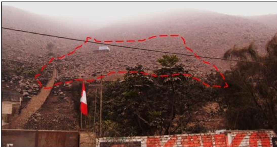
Figura 18: La línea segmentada de color rojo muestran caídas de rocas en el extremo norte del frontis de la planta de Sedapal.
