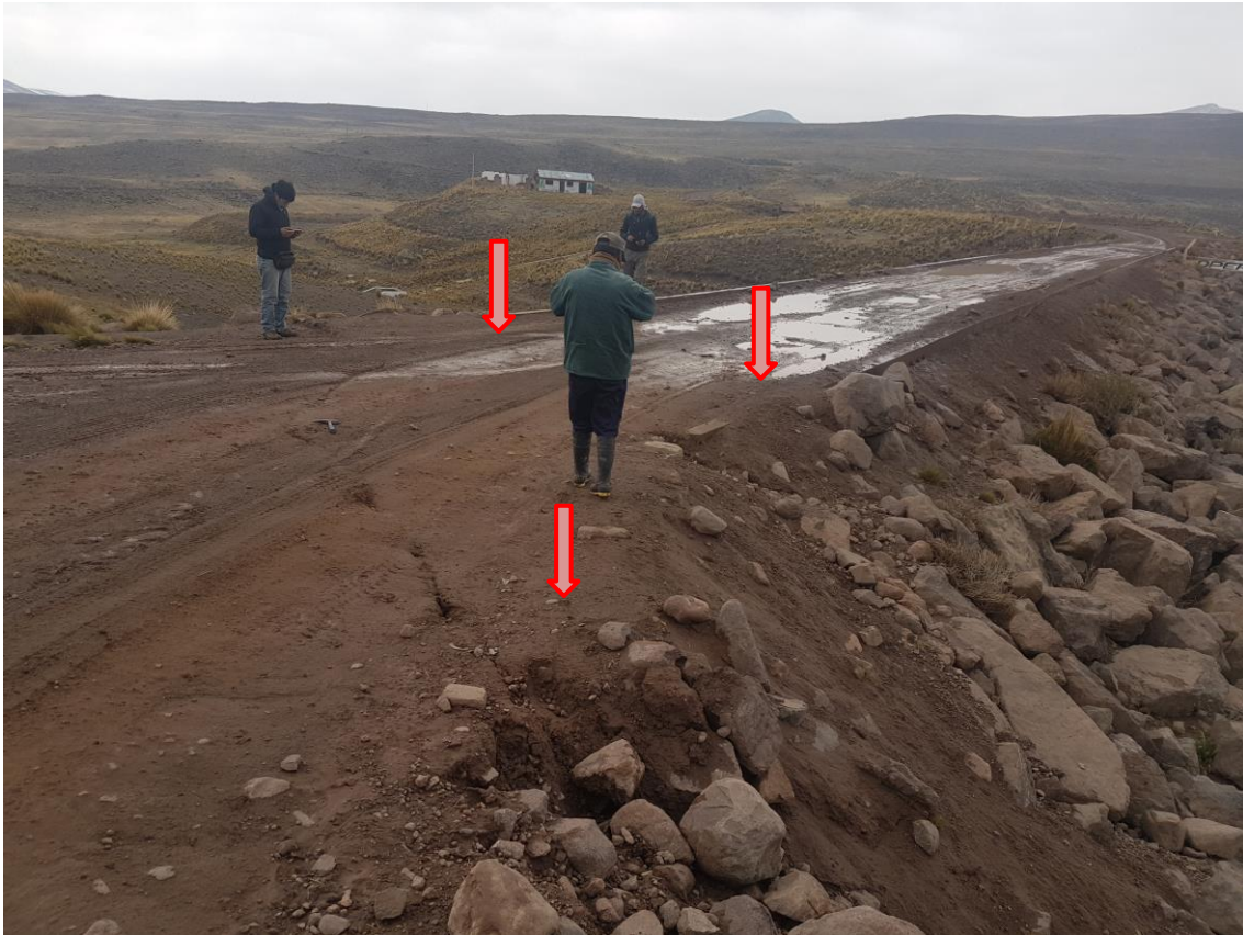
Foto 09. Grieta en la margen izquierda del dique de la represa Saguanani con presencia de grietas, por efecto del sismo ocurrido el 01 de diciembre.
