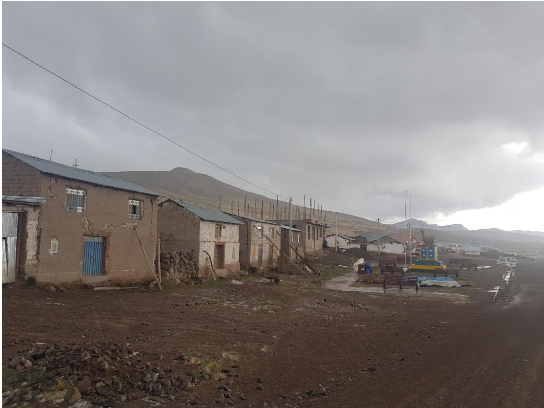
Foto 05: Daños en viviendas, la mayoría de viviendas se encuentran agrietadas. Poblado Parina.
