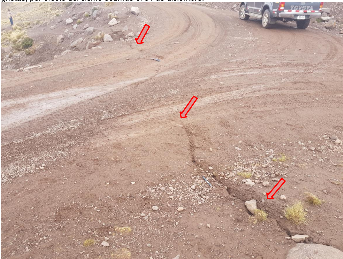
Foto 10. Detalle de la abertura y desnivel producto del asentamiento del dique en la margen izquierda.
