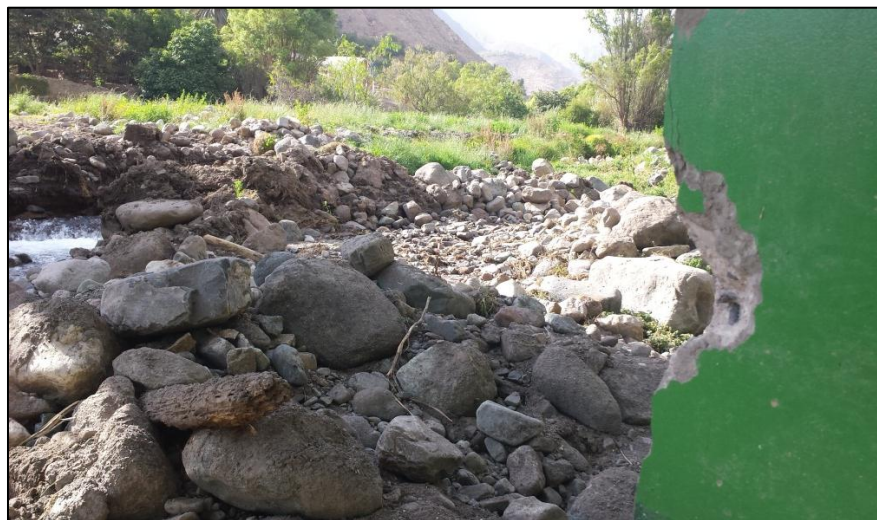
Foto 9: Daños en la estructura del puente Tipan.
