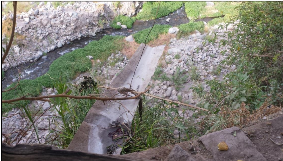
Foto 15: Vertedero de agua en una vivienda en el sector Paracolca.
