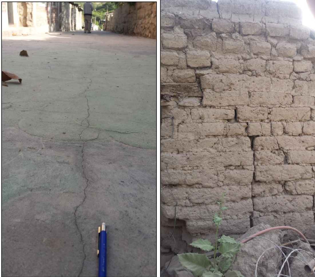
Fotos 18 y 19: Daños estructurales en infraestructura urbana en el sector de Paracolca.
