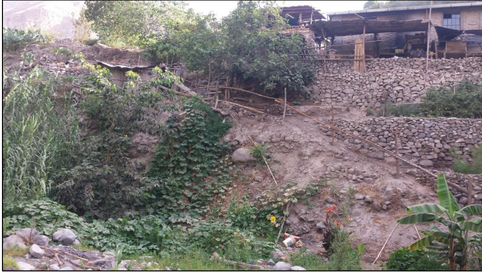
Foto 14: Vivienda susceptible a erosión lateral en el sector Paracolca.
