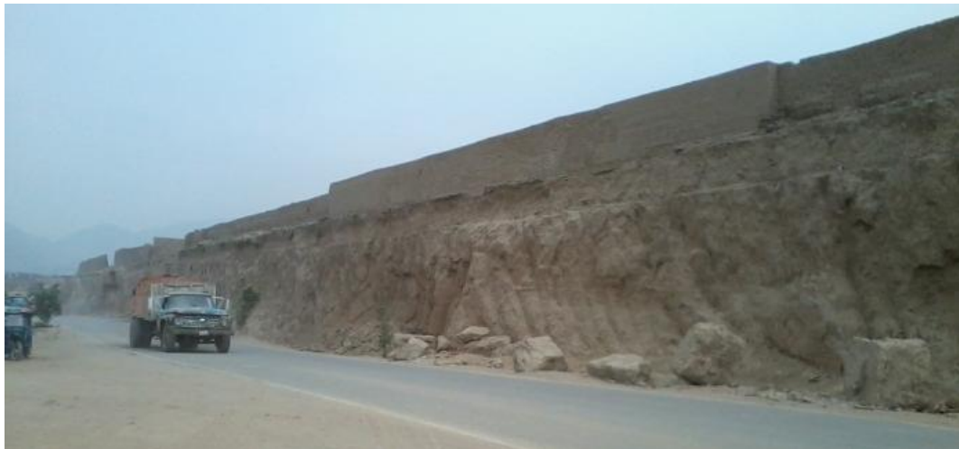
FOTOGRAFIA 33: LA VÍA PRINCIPAL, AV. LAS TORRES, ACTUALMENTE A 16 M. DEL NIVEL ORIGINAL.
