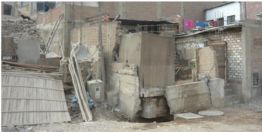
FOTOGRAFIA 30: EFECTOS DE ASENTAMIENTO DEL SUELO.
