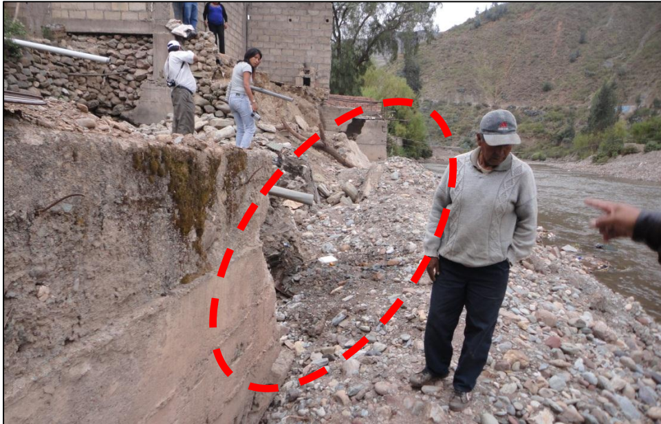
Foto 5.- Erosión fluvial que afectó defensa ribereña y vivienda.
