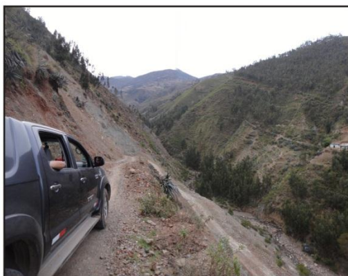
Derrumbe, por corte de talud de carretera.
