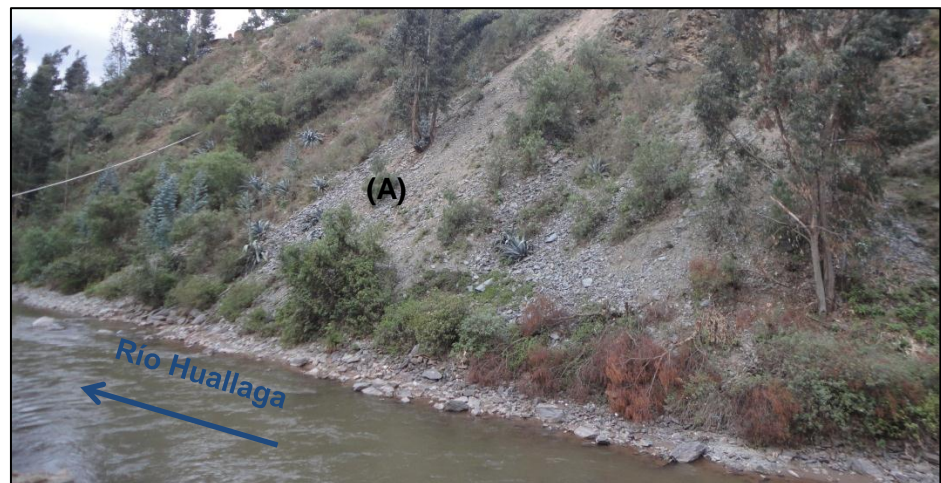
Fotos 9 y 10.- Material suelto (A), desmonte, conformado por gravas y arenas que ha hecho migrar al río hacia la margen izquierda.
