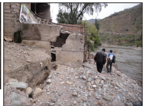
Vivienda afectada por la erosión fluvial del río Huallaga.
